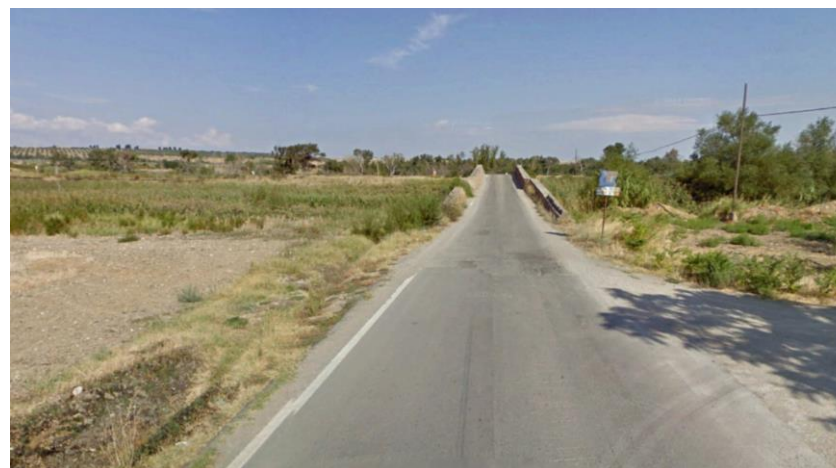
Figura 7 – Attraversamento Torrente Carapelle con SP 105. In questo tratto il passaggio del cavidotto esterno avverrà tramite TOC
