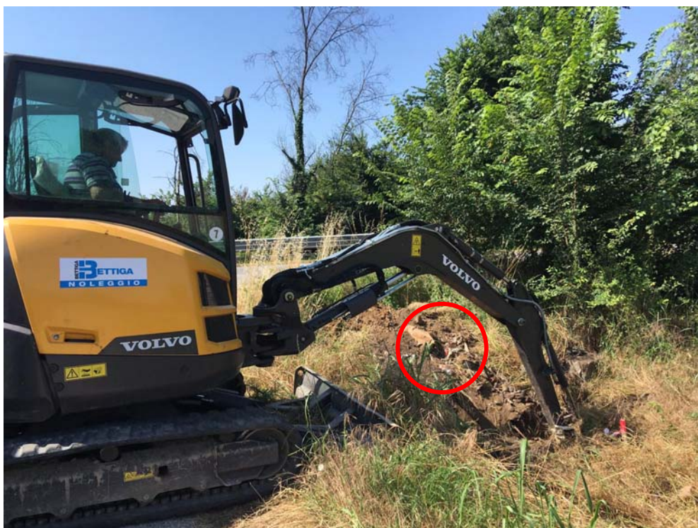
Foto n.2 : presenza RSU nello scavo numero 20
