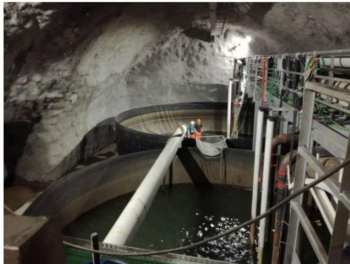
Figura 4. Foto Nicchia NE02 – Identificazione delle vasche per l'accumulo delle acque di falda drenate dalla galleria.
