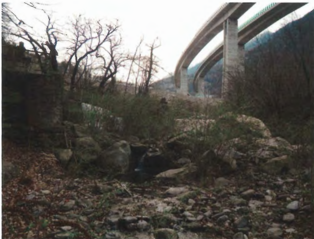
Figura 3-54: pozze d'acqua in corrispondenza del manufatto-primavera 2014.
