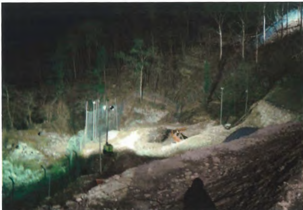
Figura 3-69: versante adiacente all'area di cantiere e limitrofo alla Valle Clarea. Si nota la costante illuminazione che può determinare un disturbo della zona (primavera 2014)
