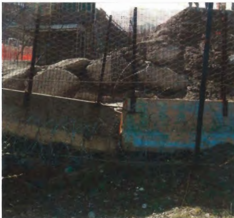
Figura 3-38: zona di uscita dell'impluvio dalla zona di cantiere. Si nota il riporto di terra all'interno della zona di cantiere con completa copertura del piccolo corso d'acqua-primavera 2013.
