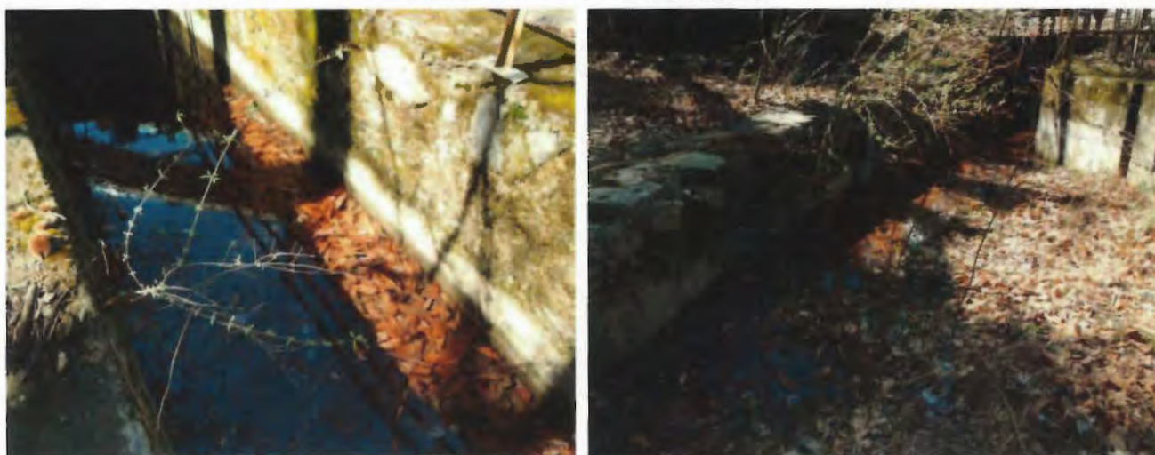
Figura 3-53: pozze d'acqua in corrispondenza del manufatto-primavera 2013.
