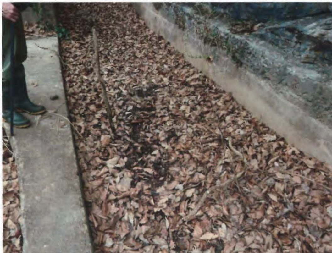
Figura 3-57: zona in corrispondenza del manufatto in disuso, in condizioni di asciutta. Marzo 2016.
