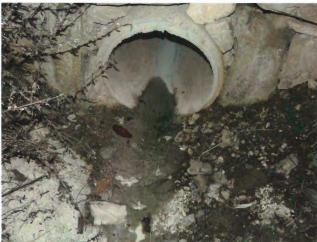
Figura 3-45: sbocco della tubazione in cemento. Si nota la piccola raccolta di acqua con larve di salamandra pezzata. Marzo 2016.
