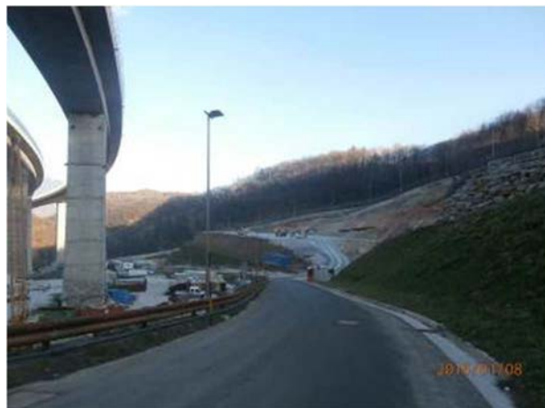
Figura 18 – Strada di accesso all'imbocco del cunicolo: si noti la presenza delle pile viadotto Clarea
