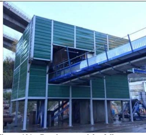
Figura 101 – Barriere acustiche della tramoggia
