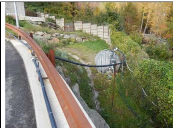
Figura 60 – Impianto automatico di bagnatura della viabilità
