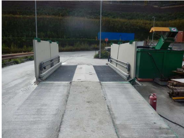
Figura 59 – Impianto lavar ruote per i mezzi
