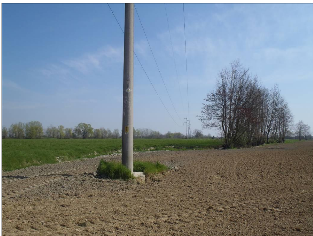
Campo nei pressi del sostegno 194.
