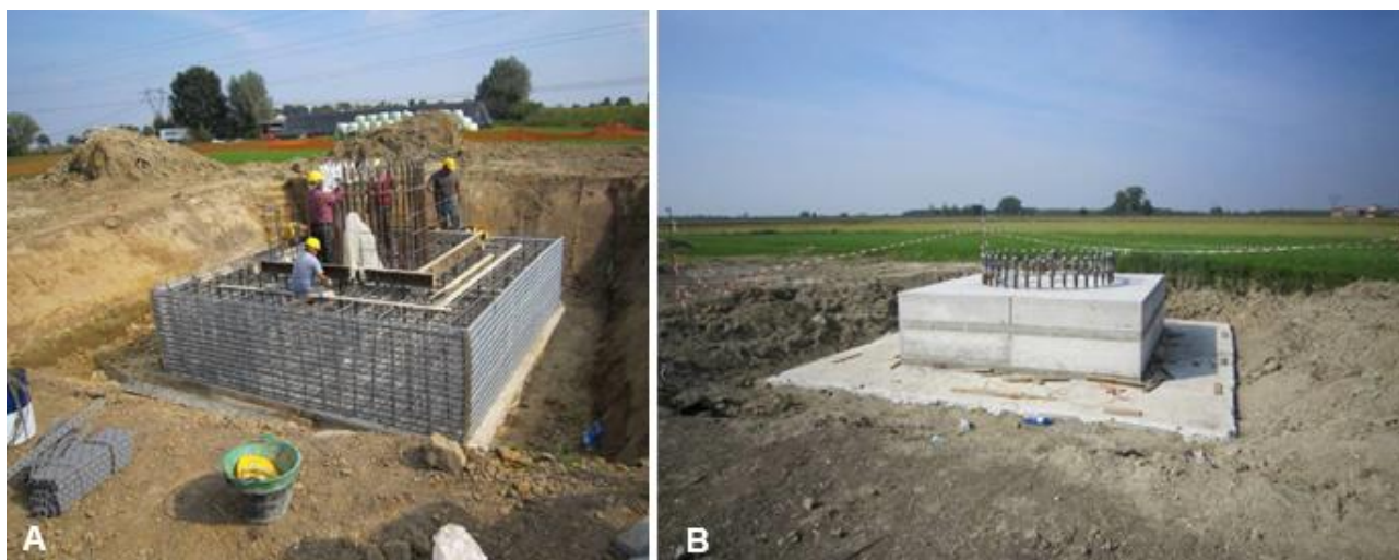
Figura 6-12 Fondazione superficiale tipo plinto a monoblocco per un sostegno monostelo. A. Fase di cassetatura. B. fondazione appena realizzata: flangia metallica dotata di tirafondi di raccordo con la parte in elevazione
