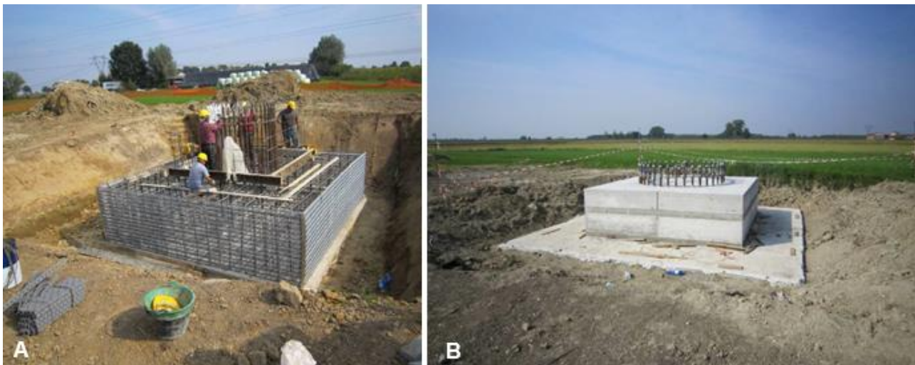
Figura 4-7 Fondazione superficiale tipo plinto a monoblocco per un sostegno monostelo. Fase di casseratura. B. fondazione appena realizzata: flangia metallica dotata di tirafondi di raccordo con la parte in elevazione
