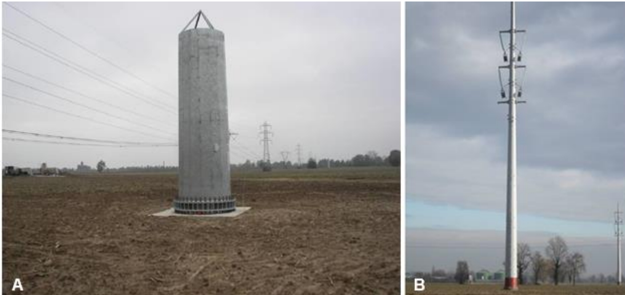
Figura 4-8 A. Realizzazione di fondazioni superficiali tipo plinto a monoblocco per un sostegno monostelo: esempio di fondazione completata e sistemazione del terreno nell'area circostante. B. Sostegno monostelo montato: carrucole collegate alle catene degli isolatori nella fase che precede la "tesatura" dei conduttori
