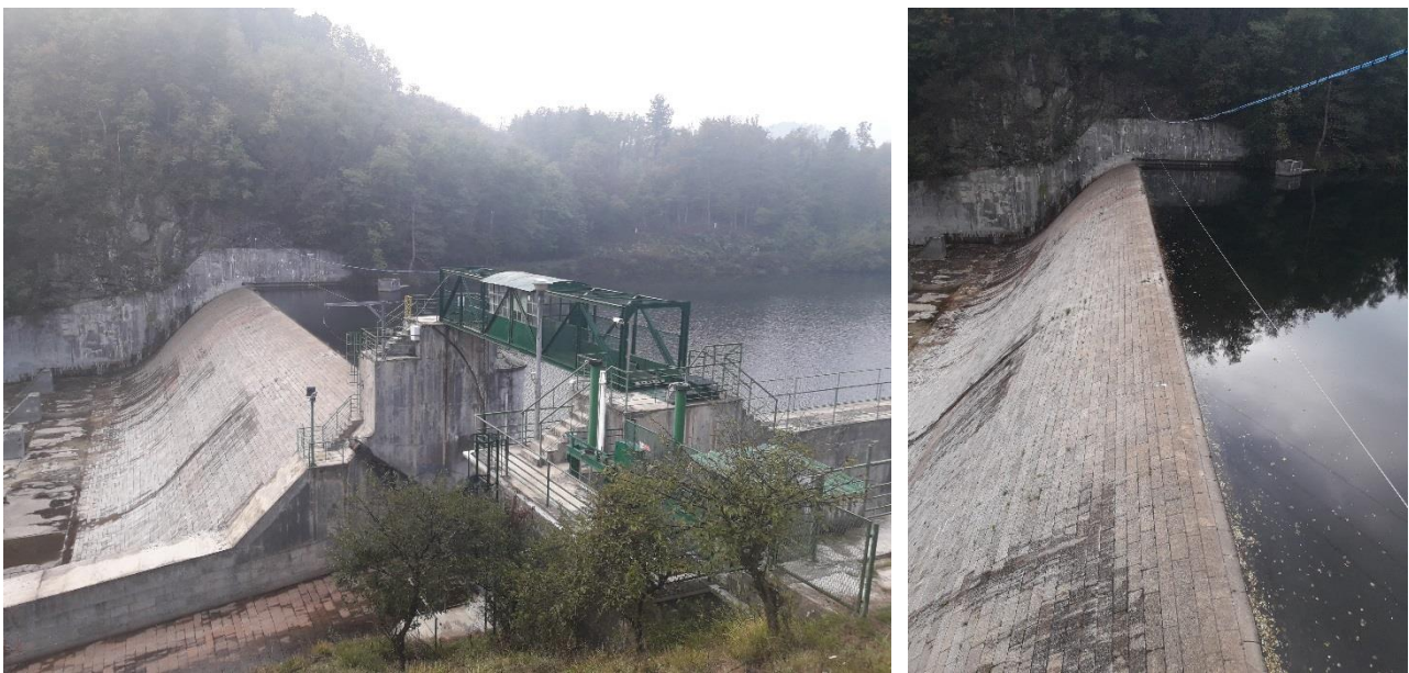
Figura 6 - Vista delle perdite d'acqua in corrispondenza dei giunti di dilatazione.
