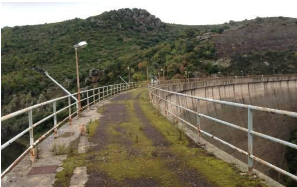
Figura 5 – Coronamento - pavimentazione da rinnovare
