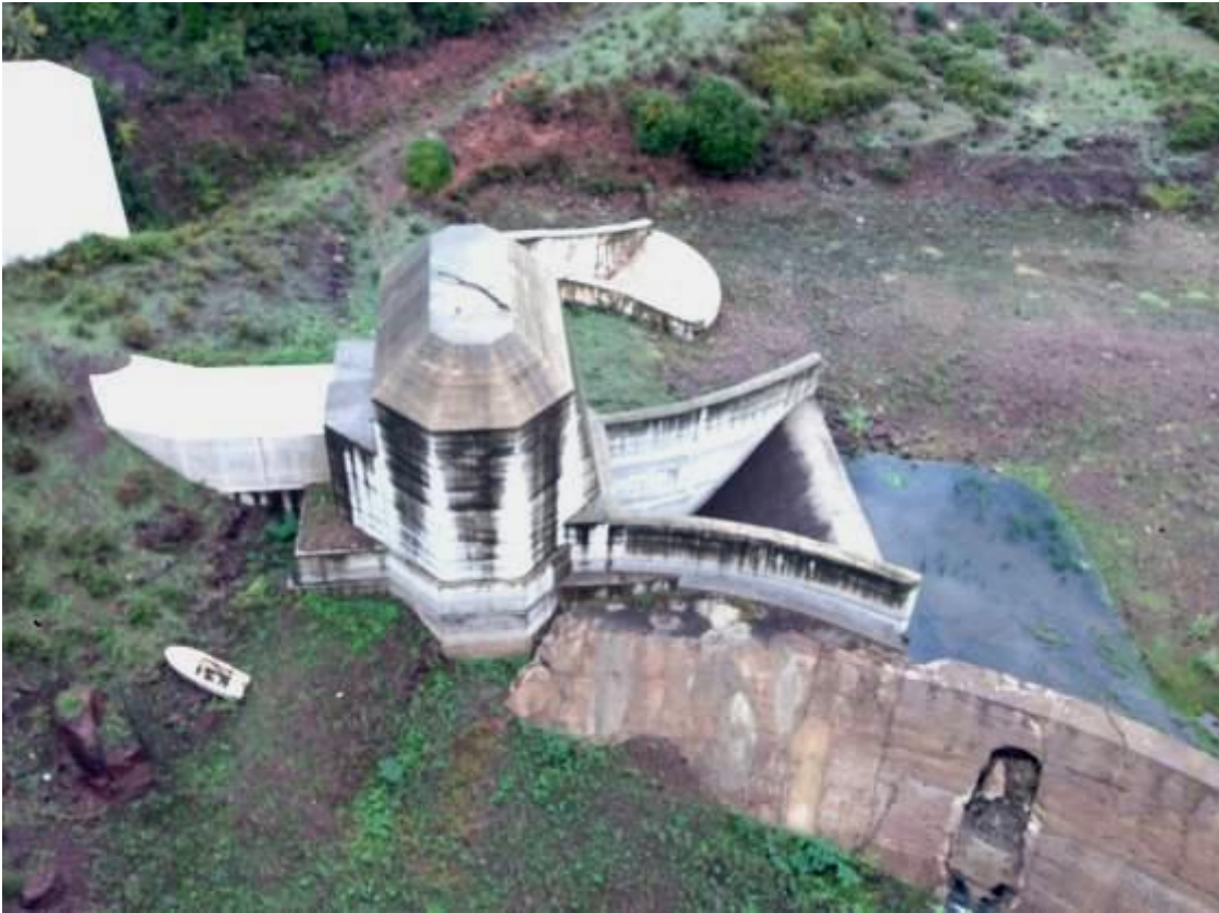
Figura 1 panoramica della camera di manovra e sfioratori dello scarico di fondo e dello scarico di alleggerimento
