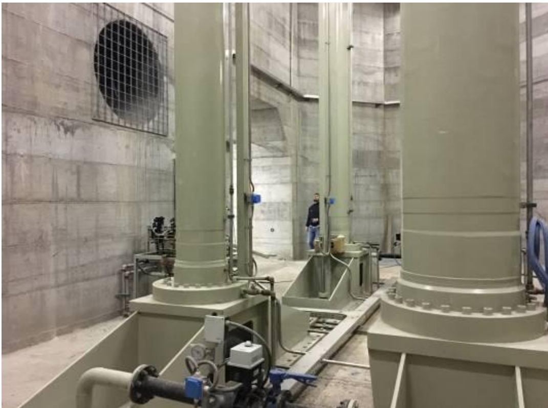
Figura 14 - Camera di manovra nuove paratoie - particolare cunicolo per presa d'aria a parete
