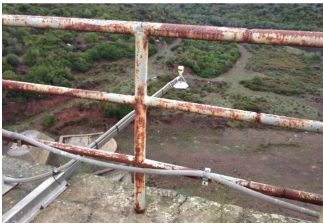
Figura 6 Coronamento - Parapetto da sostituire
