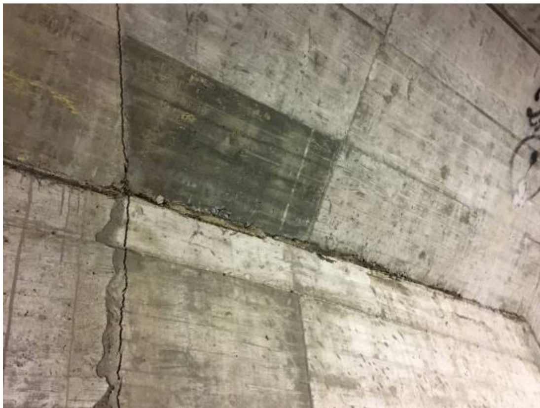
Figura 12 - Galleria di collegamento tra camere di manovra - particolare giunti di ripresa e di dilatazione
