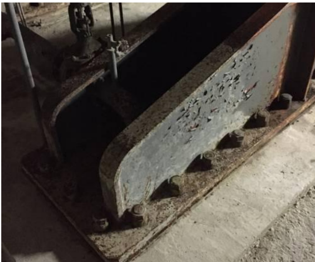
Figura 15 - Camera di manovra vecchie paratoie - particolare struttura in acciaio da riqualificare
