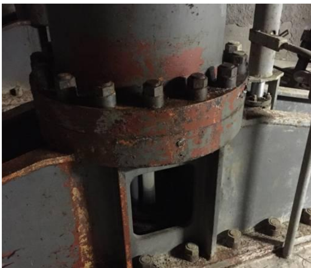
Figura 16 - Camera di manovra vecchie paratoie - particolare struttura in acciaio da riqualificare
