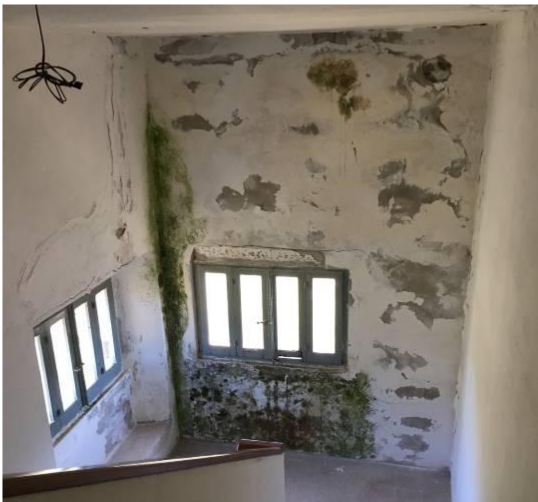
Figura 17 - Vano scala con parete sede di infiltrazioni provenienti dalla copertura e dalla facciata
