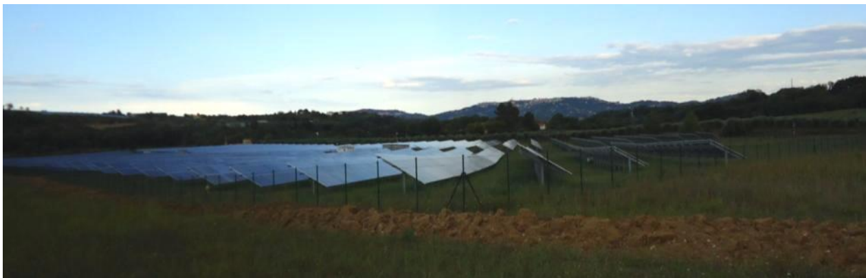
Figura 5.m: Rosciano – Impianto Fotovoltaico
