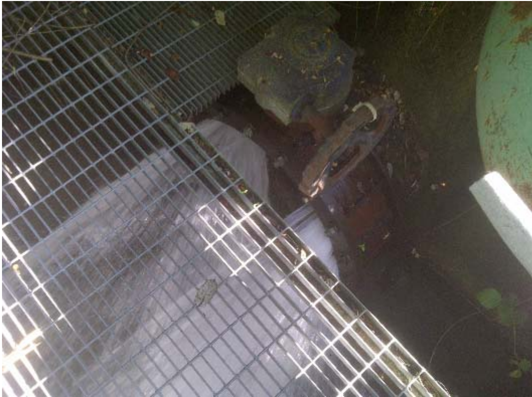
Figura 2-4: Vista saracinesca alimentazione invaso.
