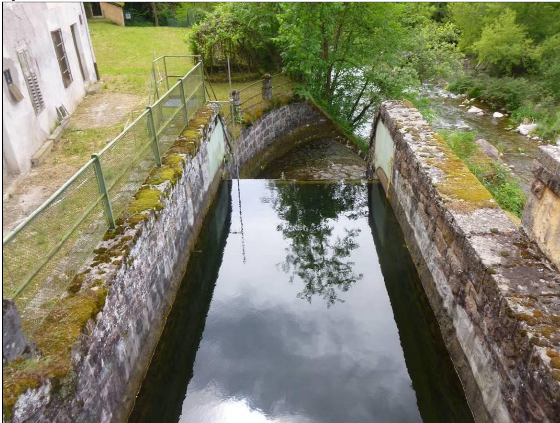
Figura 3-18: il canale di scarico nel Torrente Avisio
