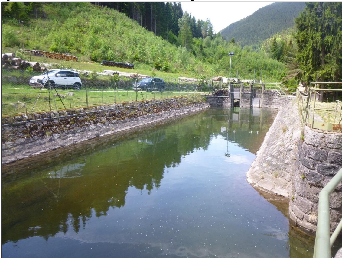
Figura 3-3: la vasca di carico della derivazione sul Rio Brusago
