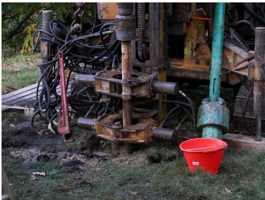
Figura 25 - Macchina operatrice per la realizzazione di micropali tubfix; sistema di scavo a rotopercussione
