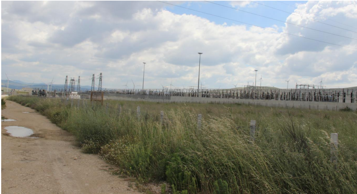
Figura 6 – Stazione RTN 380 kV “Deliceto” di proprietà Terna
