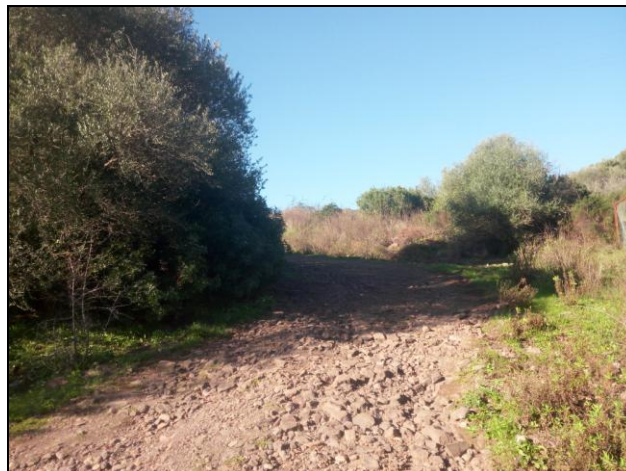
Figura 15 Particolare del fondo stradale sconnesso da risistemare
