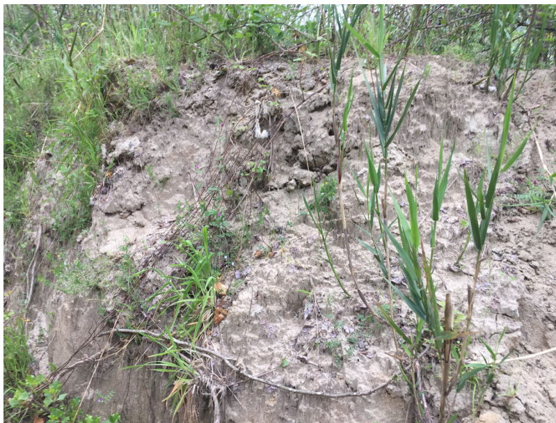
Foto 4.5 - Porzione del corpo di frana associato ad un movimento gravitativo riscontrabile nel tratto iniziale del tracciato stradale.
