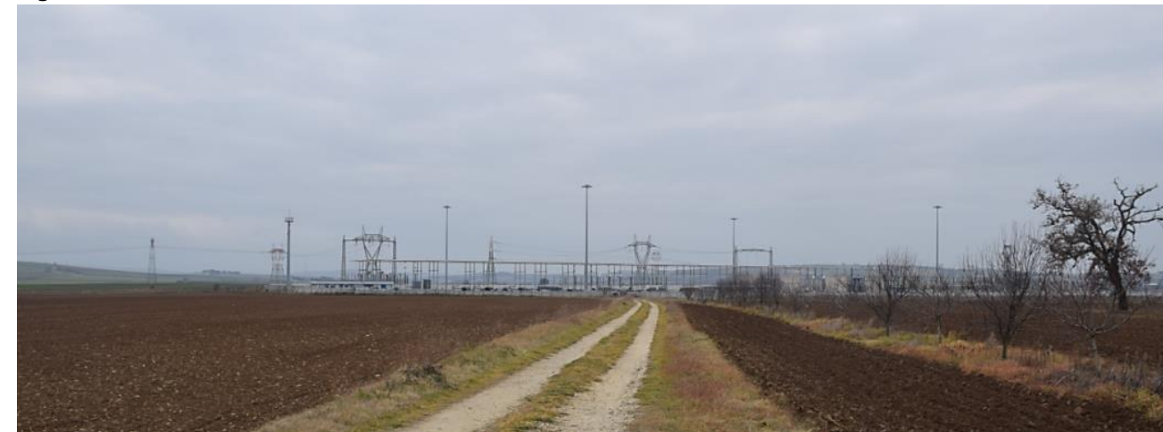
Figura 2.14 Area Stazione TERNA 380/150 kV
