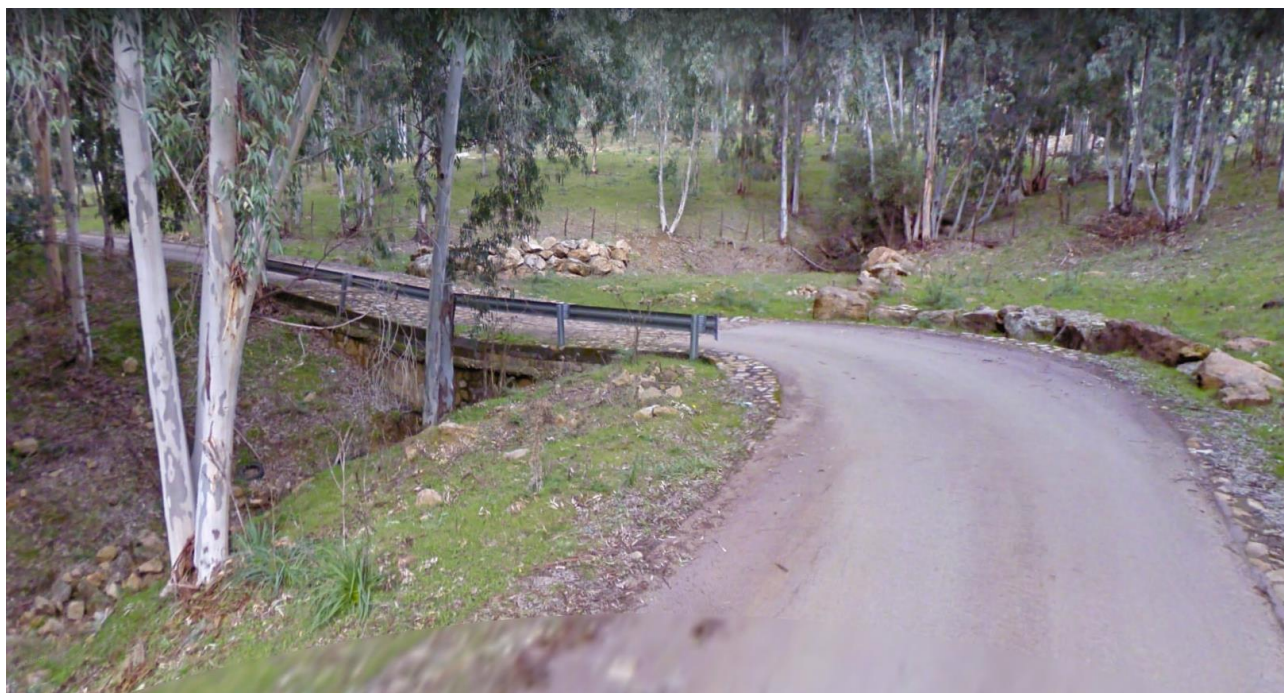
Figura 8.6: Esempio di criticità per la quale è previsto un intervento di Tipo 1
