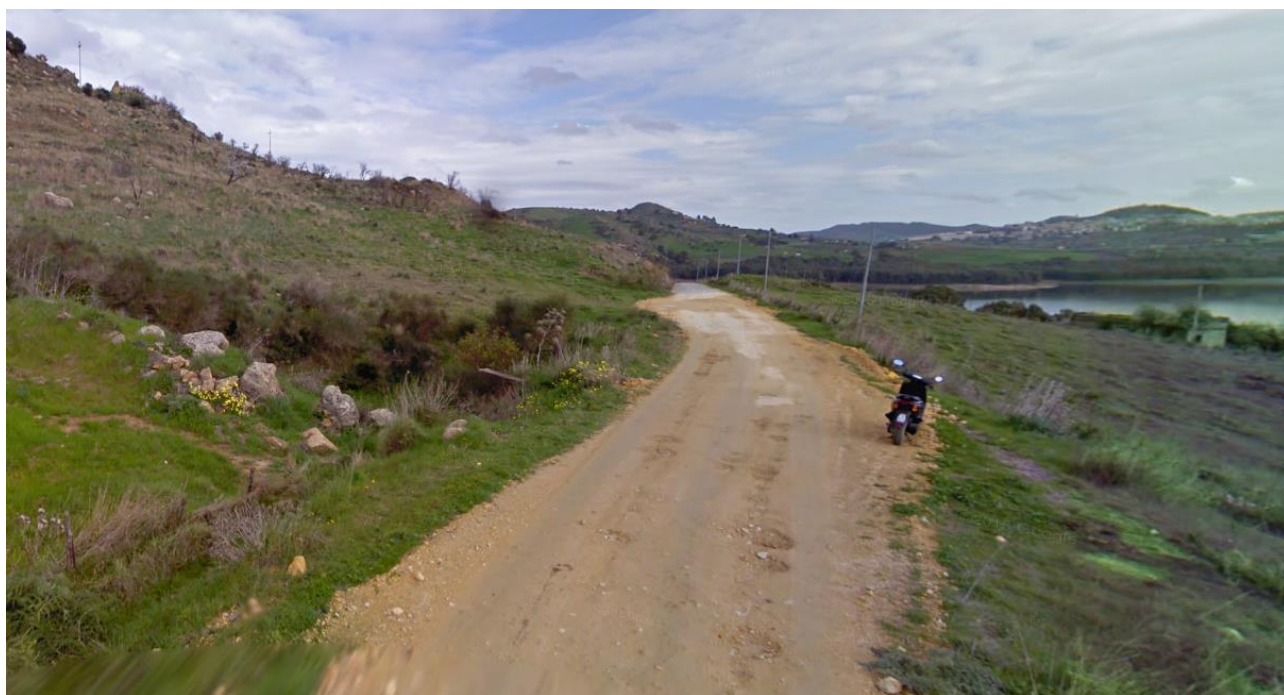
Figura 8.7: Esempio di criticità per la quale è previsto un intervento di Tipo 2
