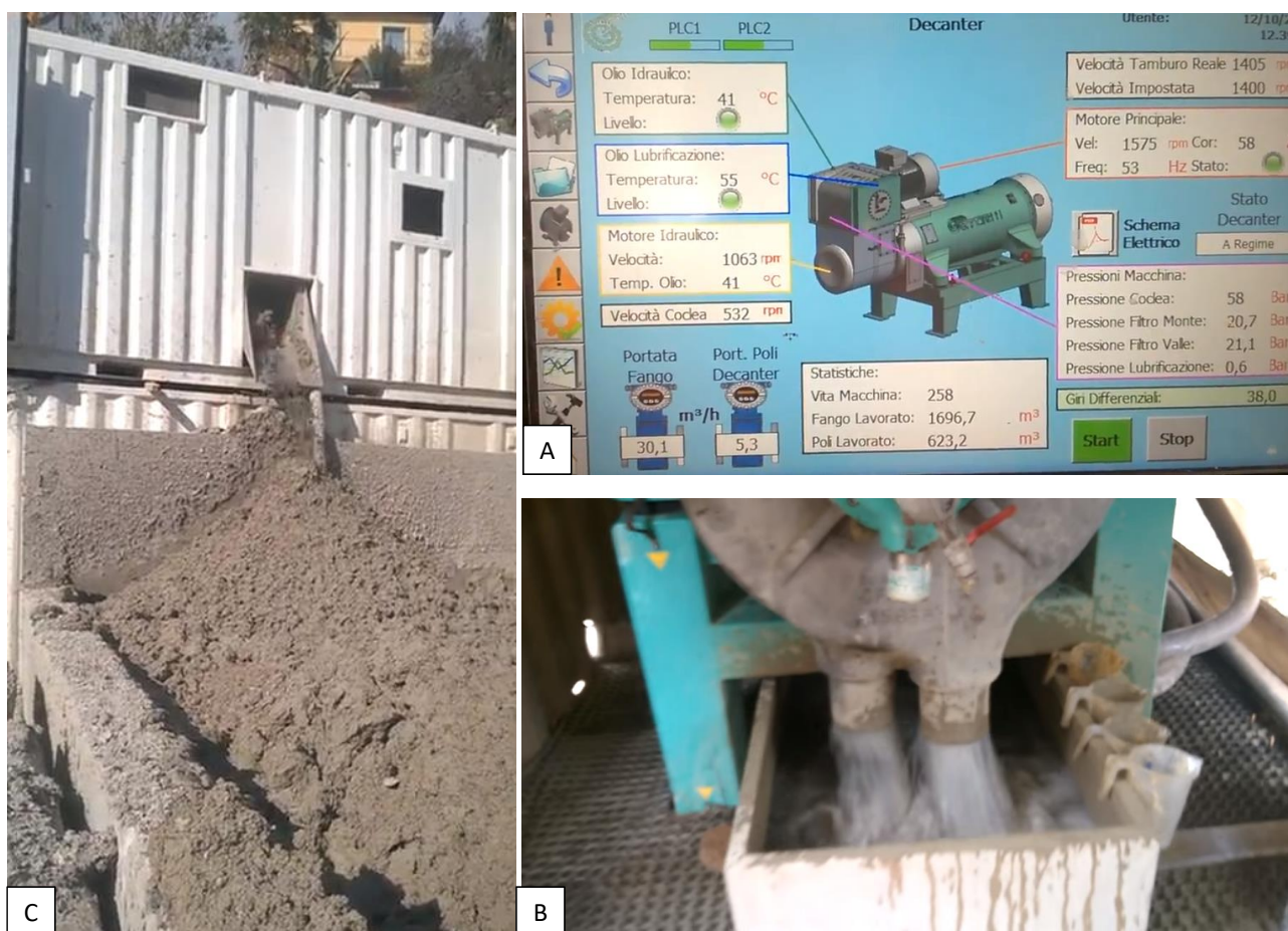
Figura 5.14: impianto di ispessimento in funzione: A: controllo o computerizzato; B scarico acque; C scarico fanghi.
