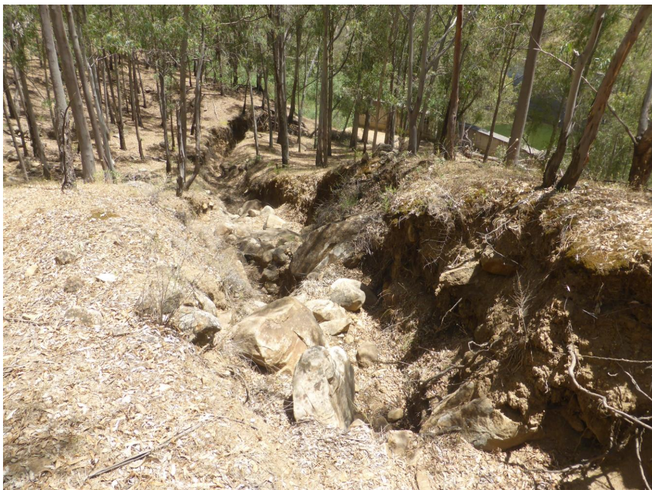
Figura 6.11: Vista dei fenomeni di erosione sul versante in sinistra idraulica.
