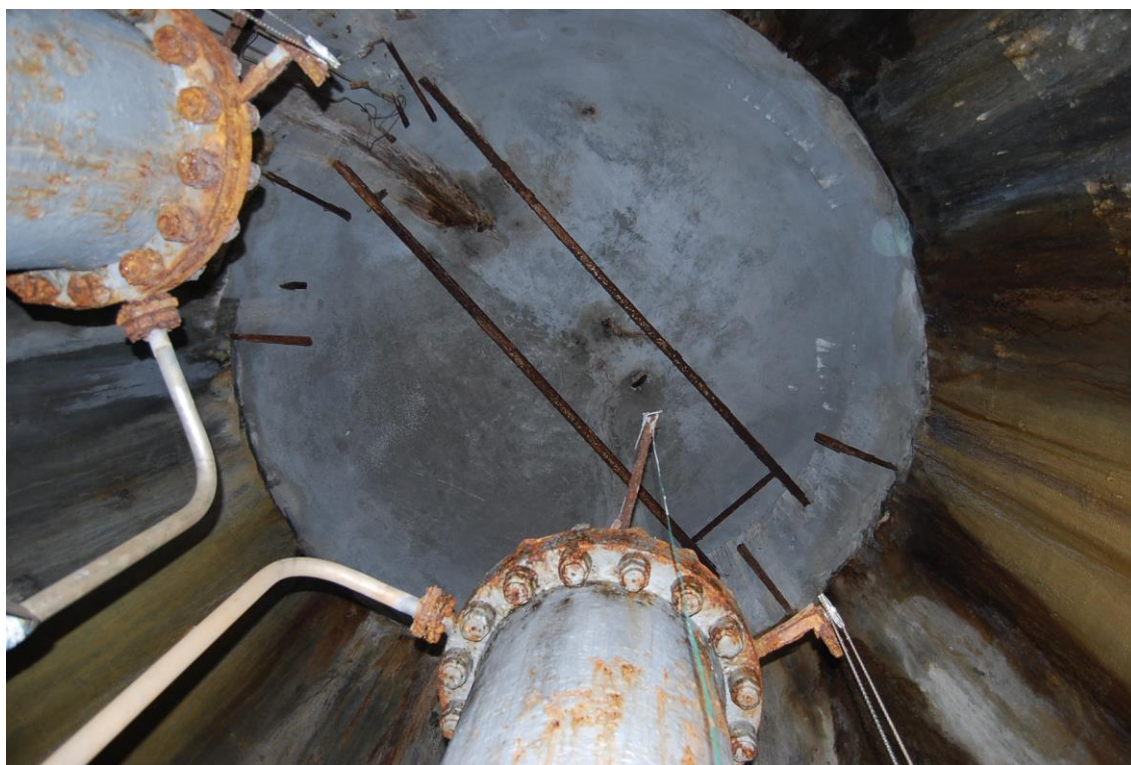
Foto 25 - Camera di manovra delle paratoie dello scarico di fondo - Calotta
