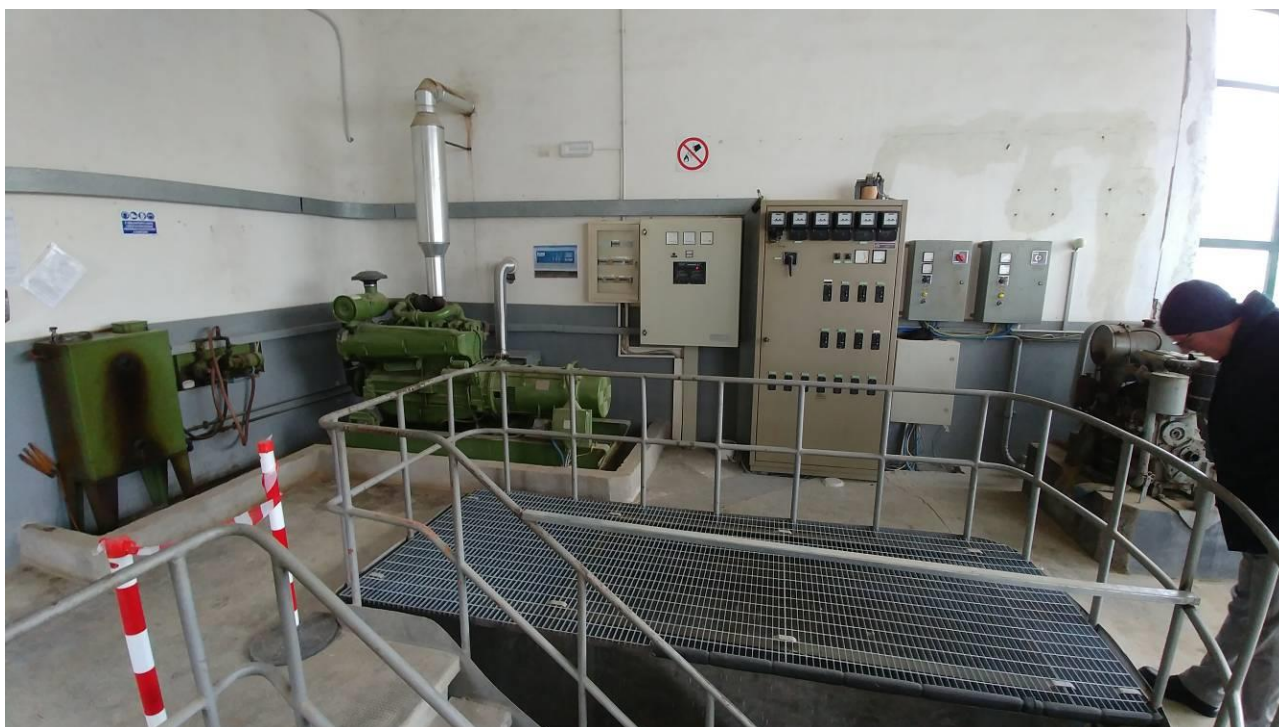
Foto 15 - Interno della struttura di accesso al pozzo - Strumentazione di manovra e controllo
