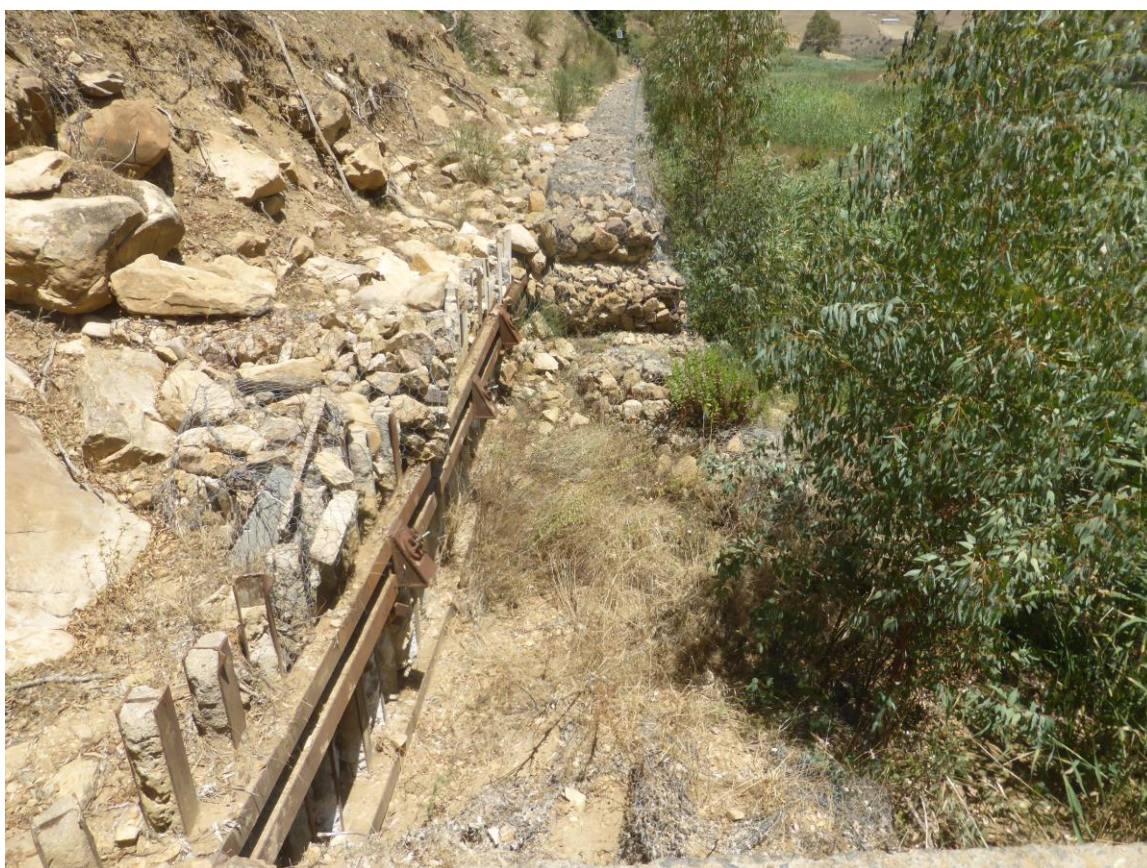
Foto 44 - Versante in sponda sinistra, crollo parziale dell'opera di ritenuta in gabbioni
