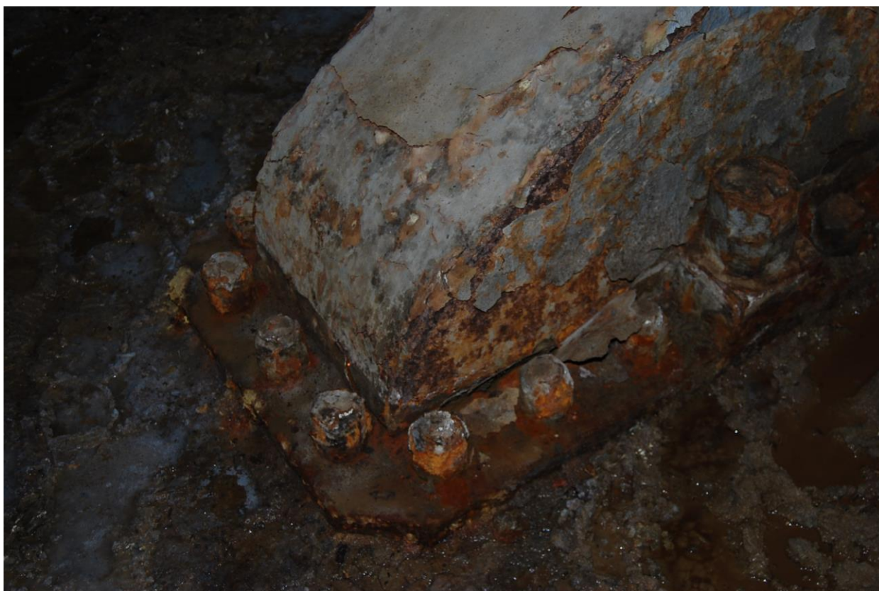
Foto 29- Camera di manovra delle paratoie dello scarico di fondo - dettaglio degrado connessioni bullonate
