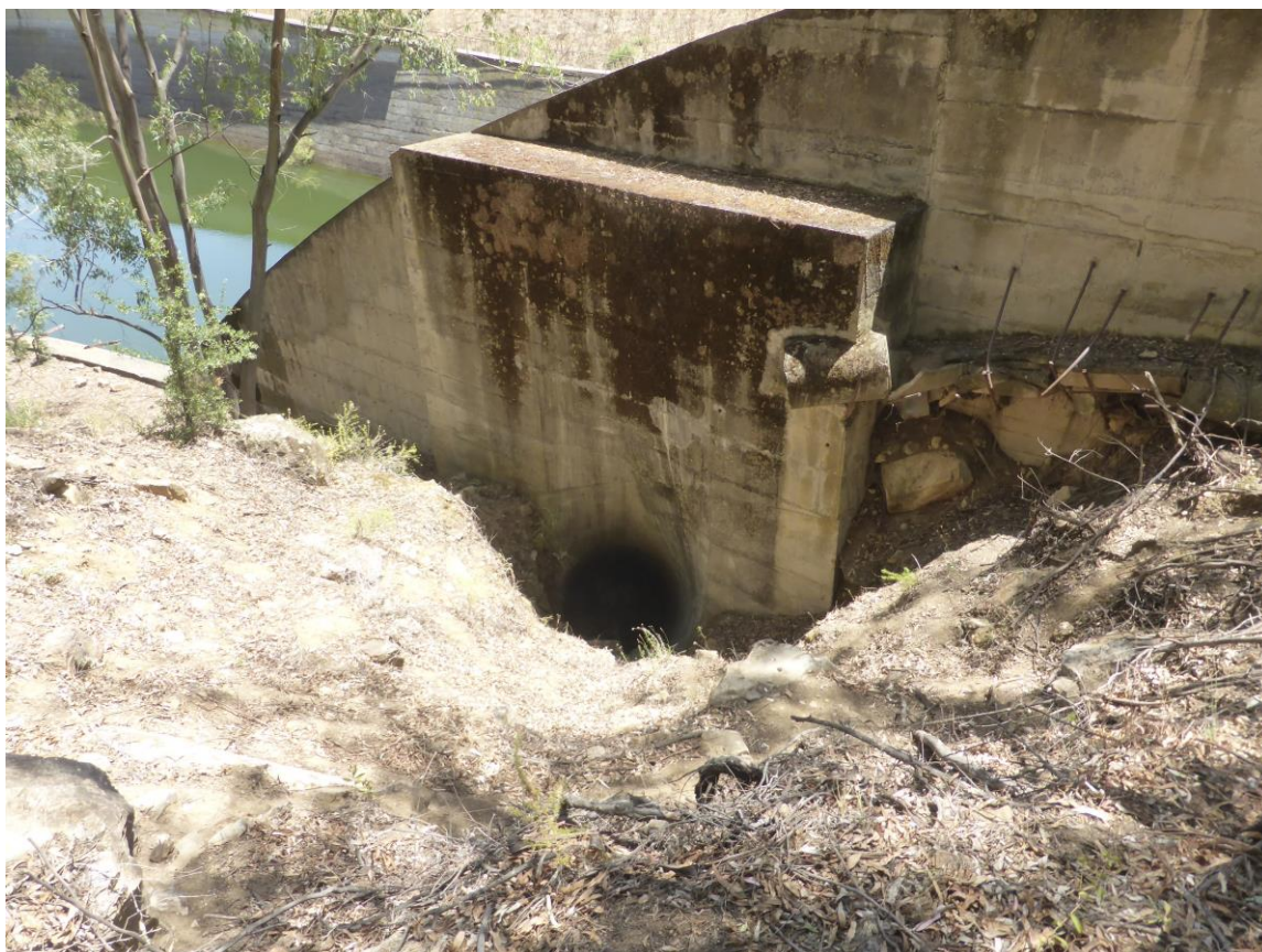
Foto 42 - Versante in sponda sinistra, inghiottitoio soggetto a intasamento
