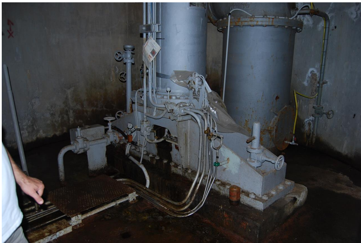
Foto 22 - Paratoia e relativi organi di movimentazione della galleria di derivazione elettro-irrigua
