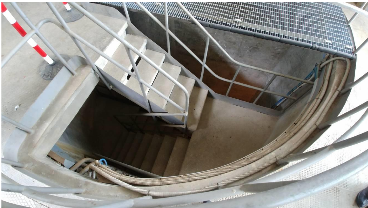
Foto 17- Pozzo di accesso alle camere di manovra
