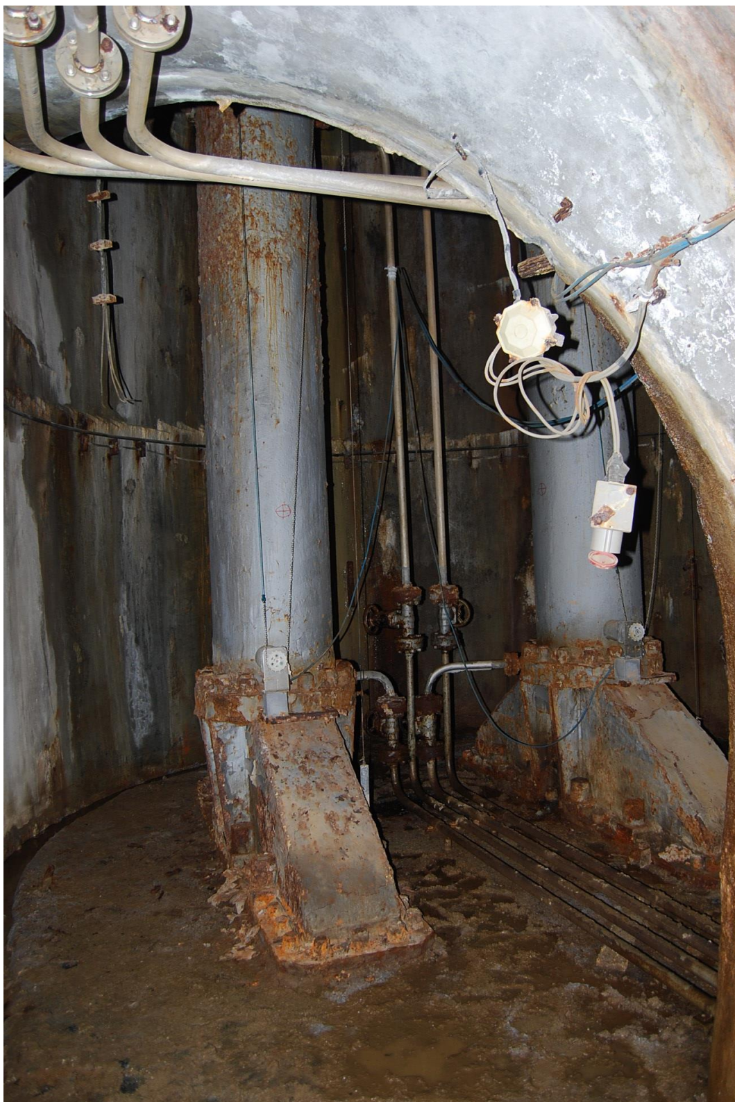
Foto 24 - Camera di manovra delle paratoie dello scarico di fondo
