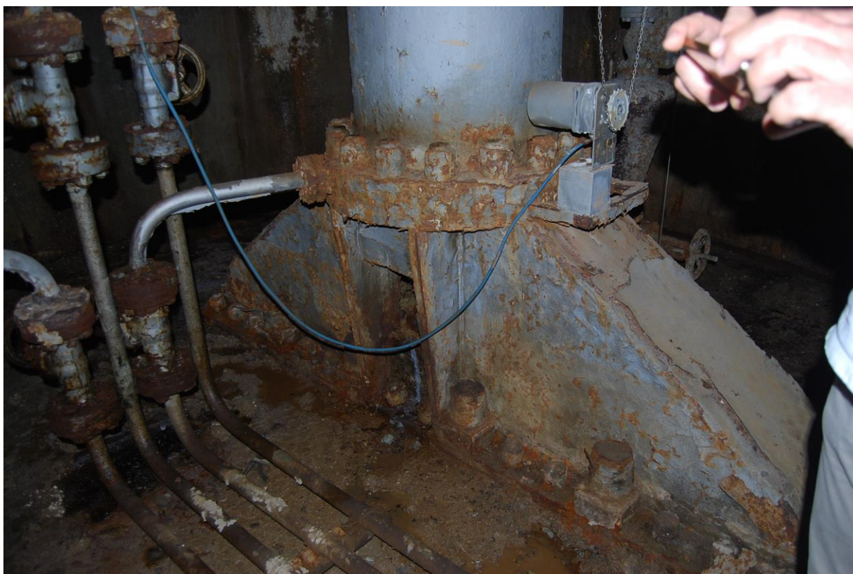
Foto 26- Camera di manovra delle paratoie dello scarico di fondo - dettaglio paratoia e collegamenti idraulici
