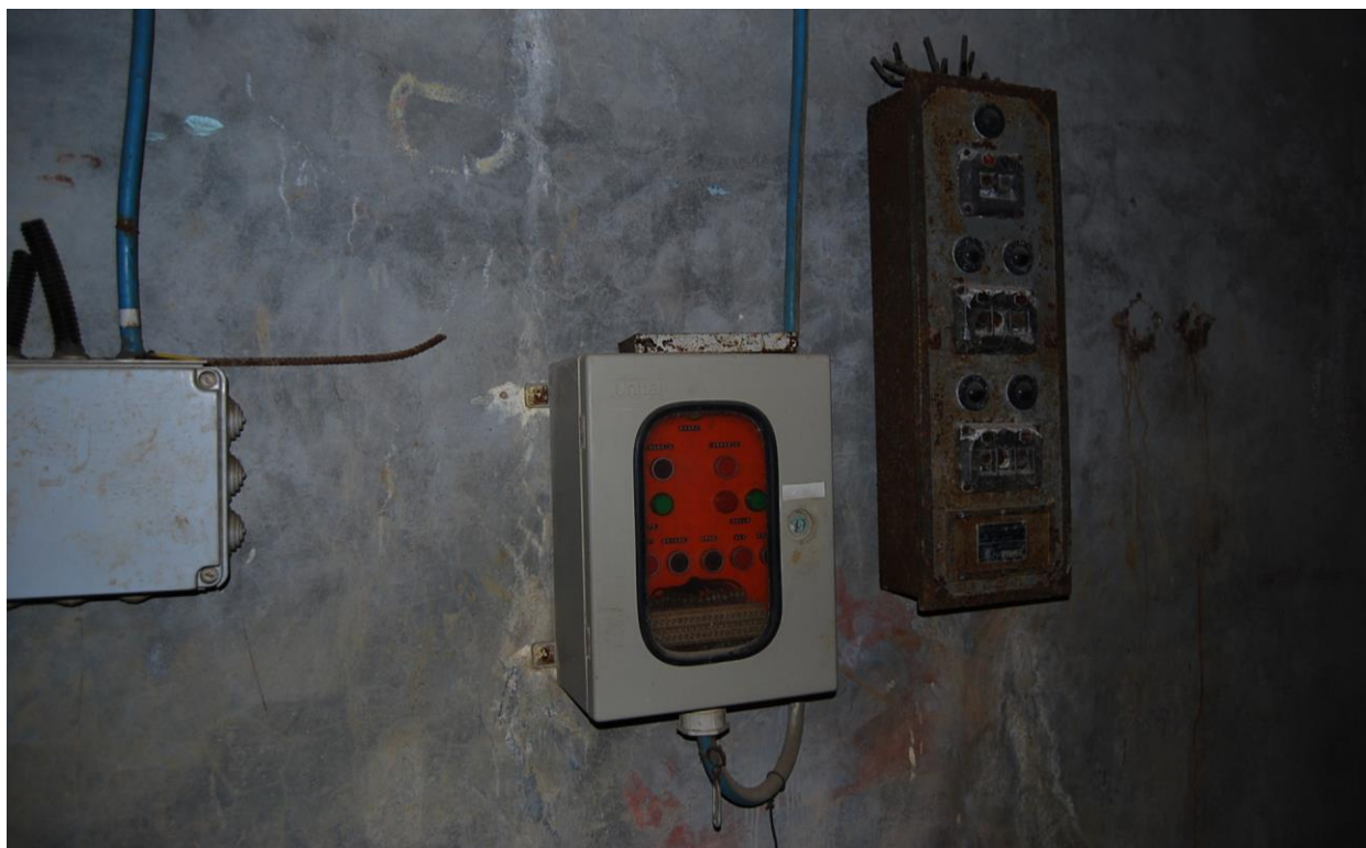
Foto 21 - Impianto elettrico camera di manovra
