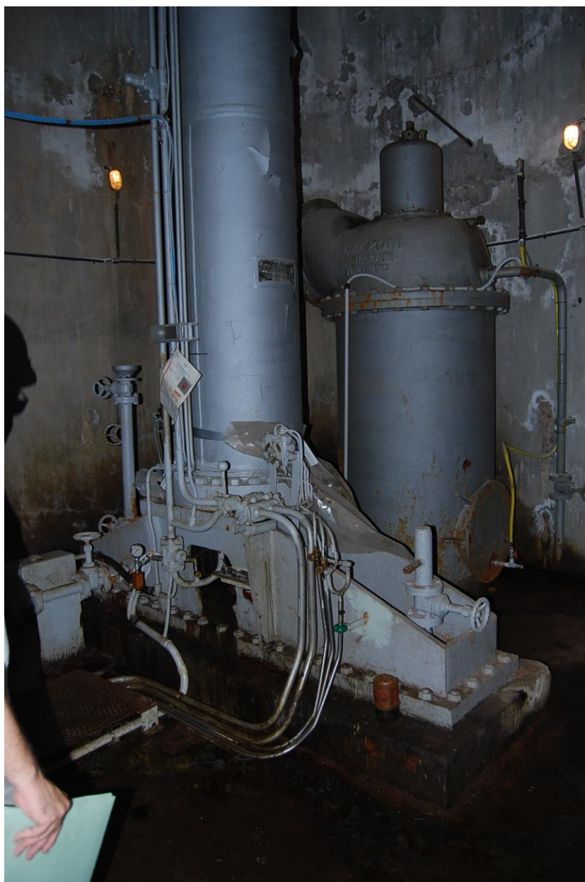
Foto 23 - Camera di manovra della paratoia e relativi organi di movimentazione della galleria di derivazione elettro-irrigua
