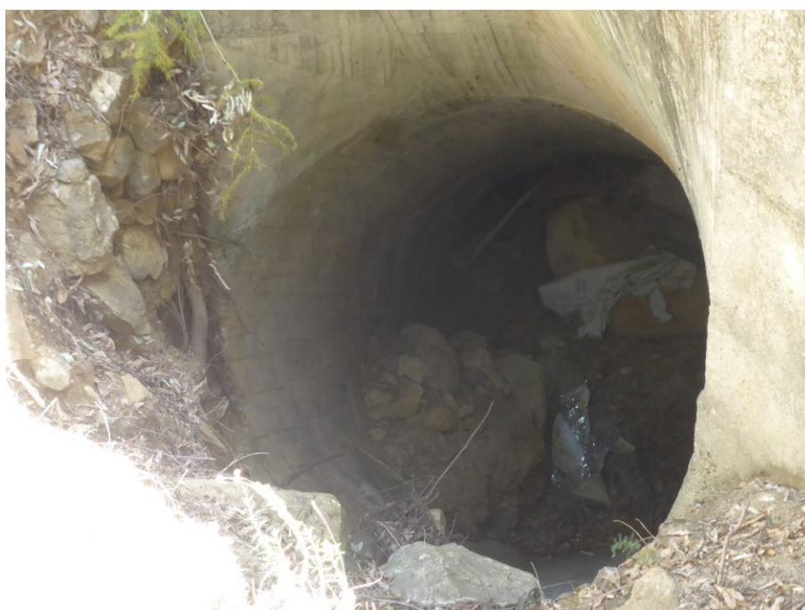
Foto 43 - Versante in sponda sinistra, dettaglio inghiottitoio soggetto a intasamento
