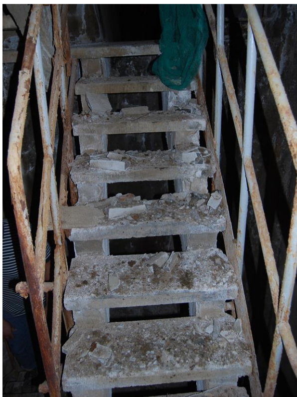
Foto 20 - Scale del pozzo di accesso - Dettaglio degrado strutturale
