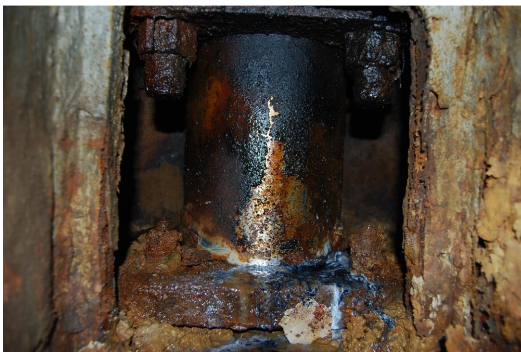
Foto 30- Camera di manovra delle paratoie dello scarico di fondo - dettaglio degrado pistone
