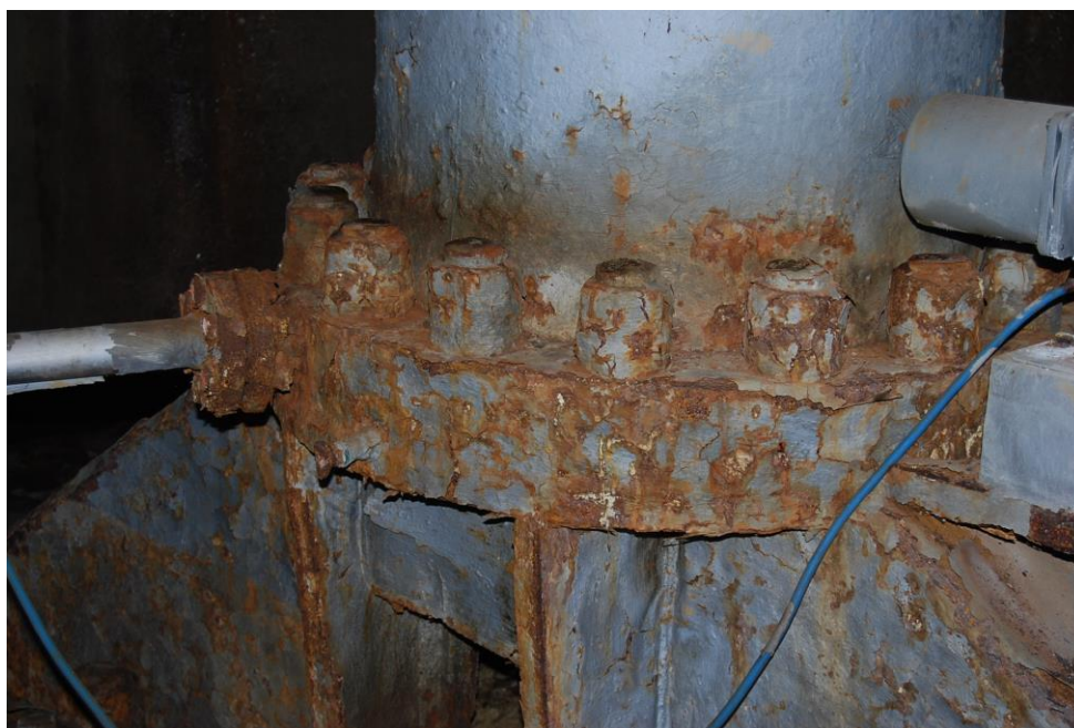
Foto 28 - Camera di manovra delle paratoie dello scarico di fondo - dettaglio degrado connessioni bullonate
