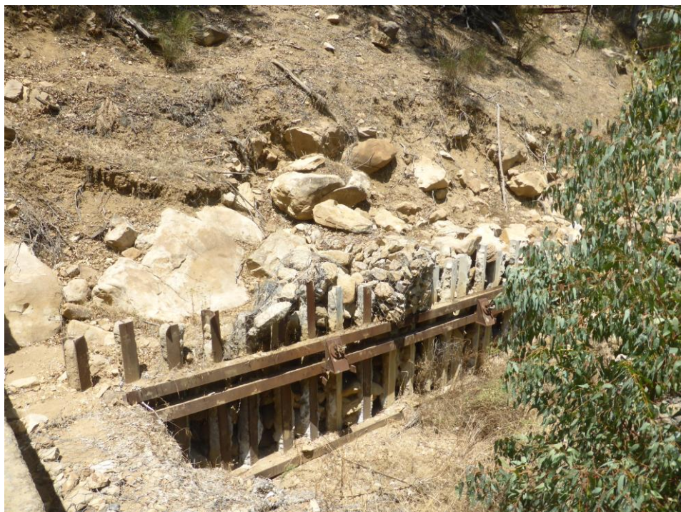
Foto 45 - Versante in sponda sinistra, dettaglio crollo parziale dell'opera di ritenuta in gabbioni
