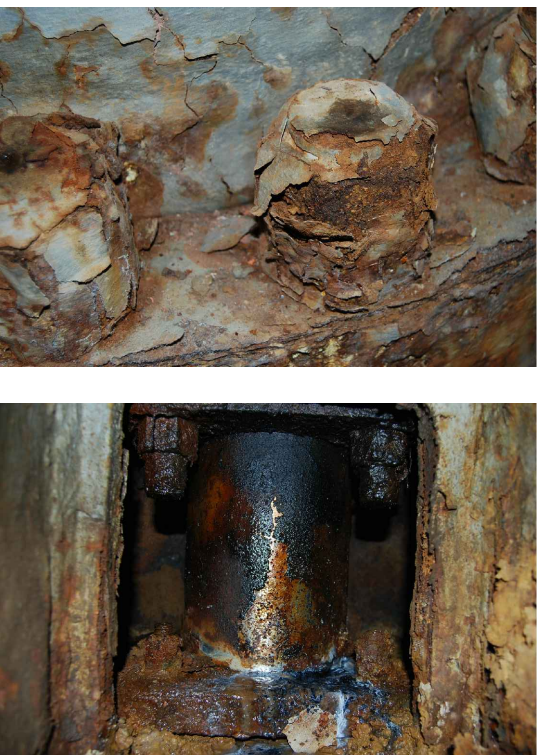
Dettaglio degrado connessioni bullonate
