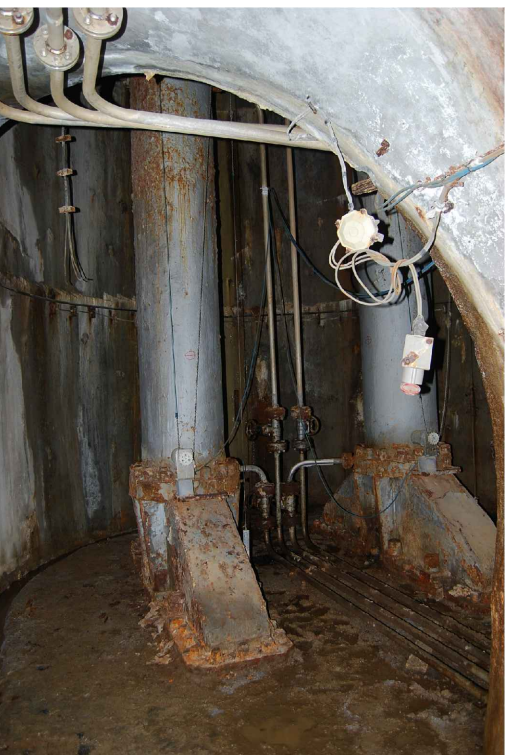
Camera di manovra delle paratoie dello scarico di fondo (FOTO 24)
