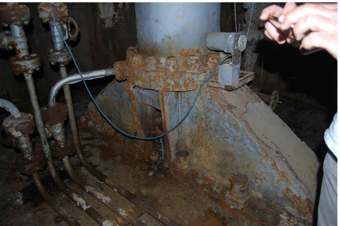
Dettaglio paratoia e collegamenti idraulici (FOTO 26)
