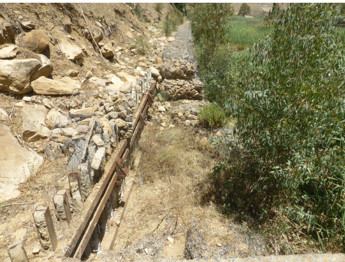
Versante in sponda sinistra - crollo parziale dell'opera di ritenuta
