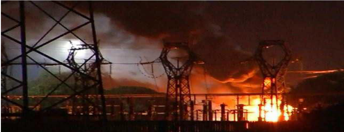
Incendio di un trasformatore da 380 KV di TERNA a Castel di Leva a Gennaio 2014
