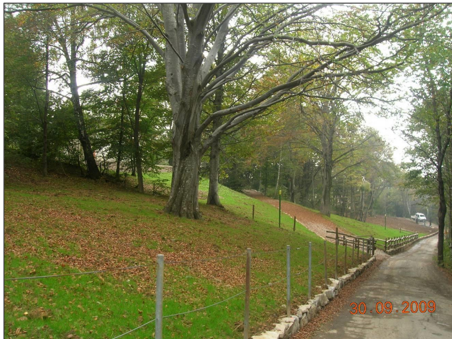
Fig. 7.2/C: Esempio di tecnica di salvaguardia di alberi posti all'interno dell'area di passaggio, dopo gli inerbimenti
