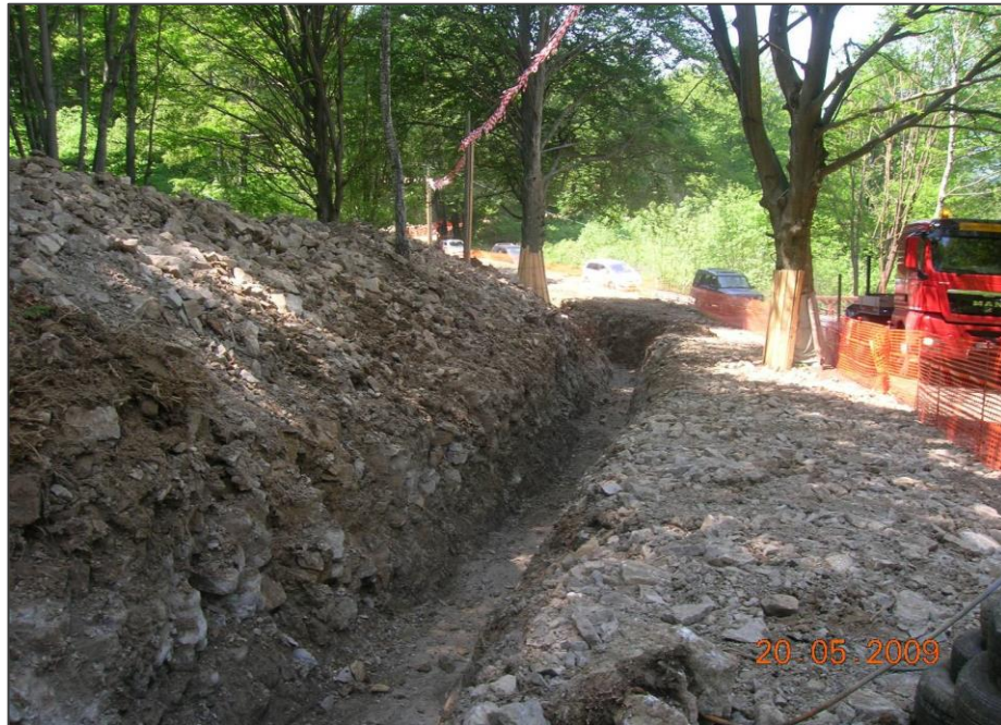
Fig. 7.2/B: Esempio di tecnica di salvaguardia di alberi posti all'interno dell'area di passaggio, in fase di cantiere
