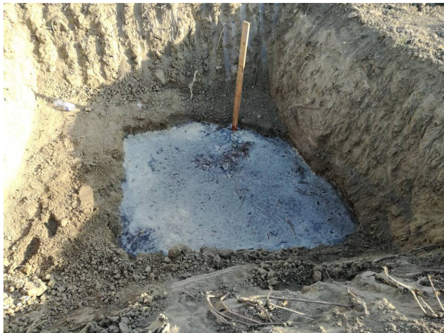
Foto3 – Pozzetto riempito di acqua
