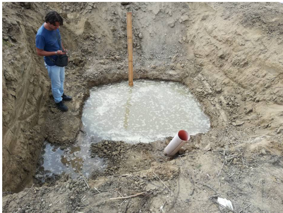
Foto 5: - Misura del livello dell'acqua nel pozzetto
