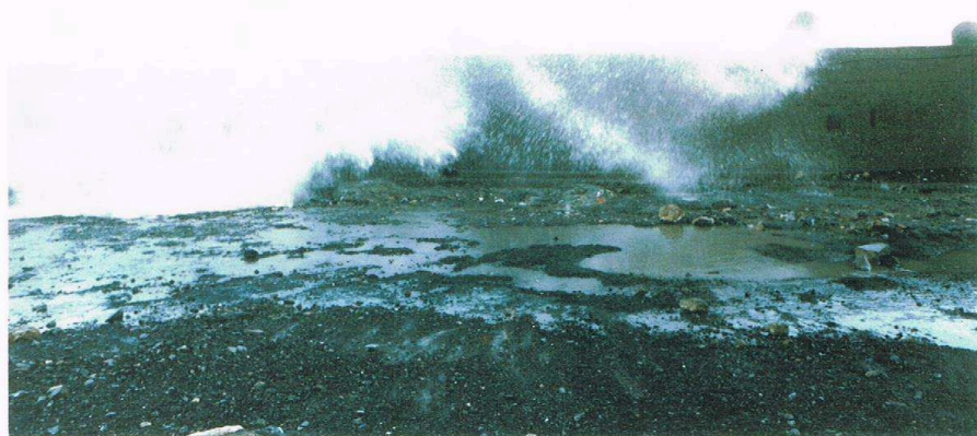
Porto di Andora (SV) - Mareggiate del febbraio '89 e novembre '92 - sono evidenziate le tracimazioni del muro paraonde
