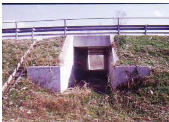
Foto 99 – Sottopasso scatolare per fauna minore (Collegamento Cimpello – Sequals – PN – Foto G. Sauli)
