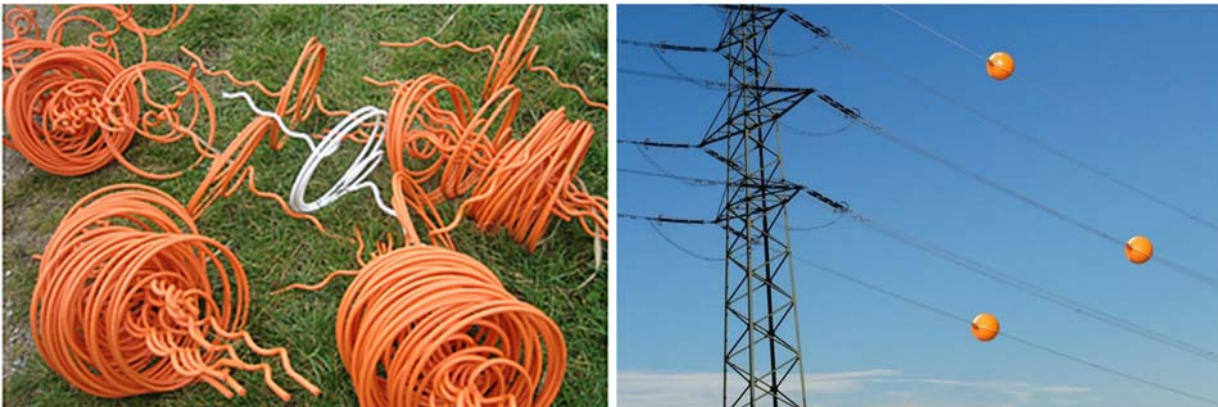
Figura 5 – Sistemi di avvertimento visivo: spirali (a sx) e sfere colorate (a dx)
