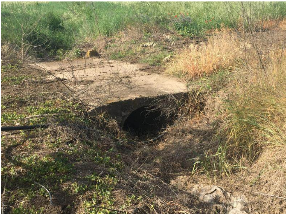
Foto P13.2: Vista del Canale Biasifficco – San Marchitto in prossimità dell’attraversamento del cavidotto esterno
