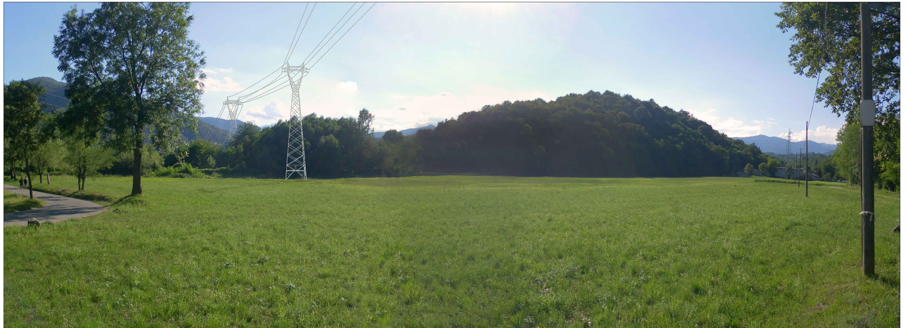
Fotoinserimento 8 - Vista dell'elettrodotto nel tratto di arrivo nella Cabina Primaria di Balangero
