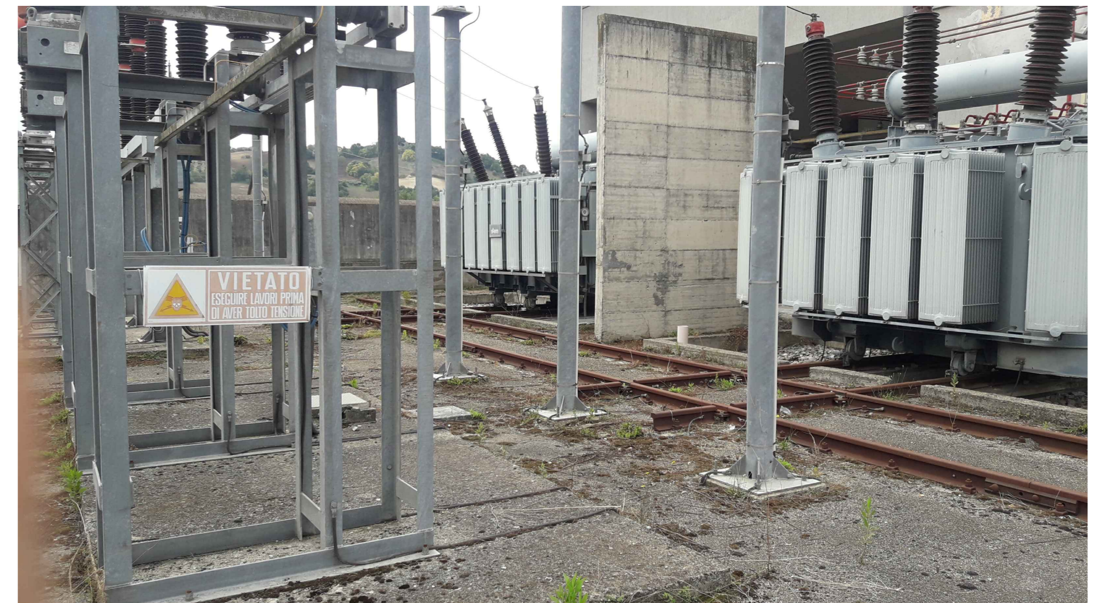
FOTO 3: Vista del piazzale SSE e trasformatori MT bt
