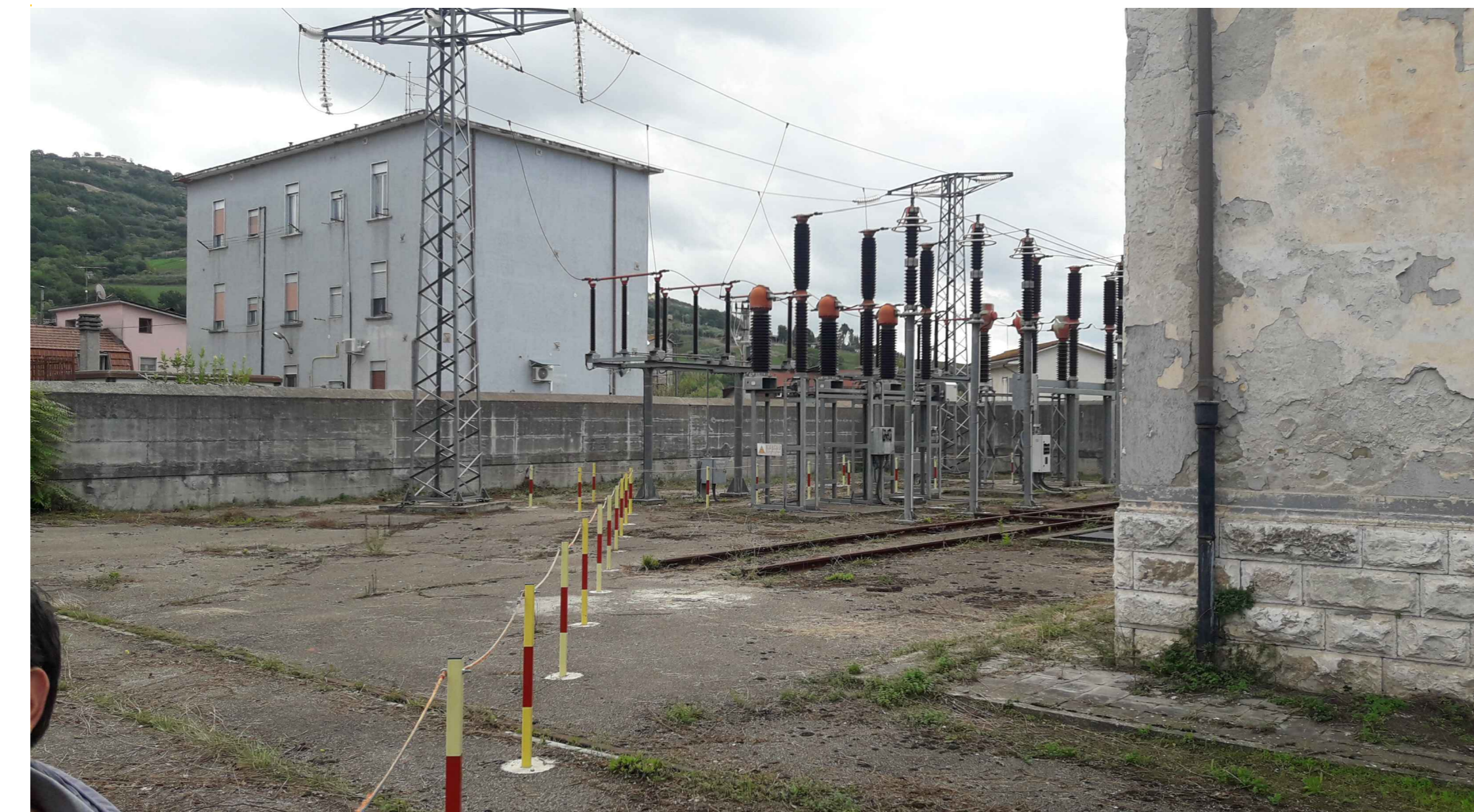
FOTO 2: Vista del piazzale SSE.
