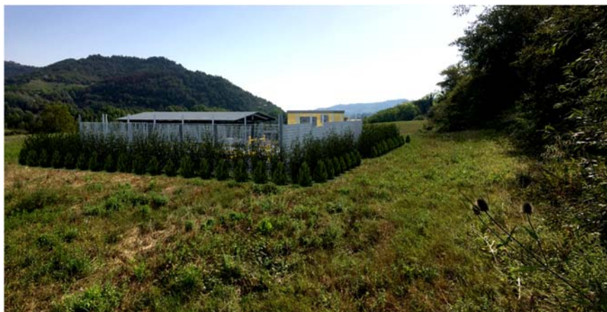
Fig. 6.2.3.3.5 - Impianto PIDA n.1 con opere di mitigazione
