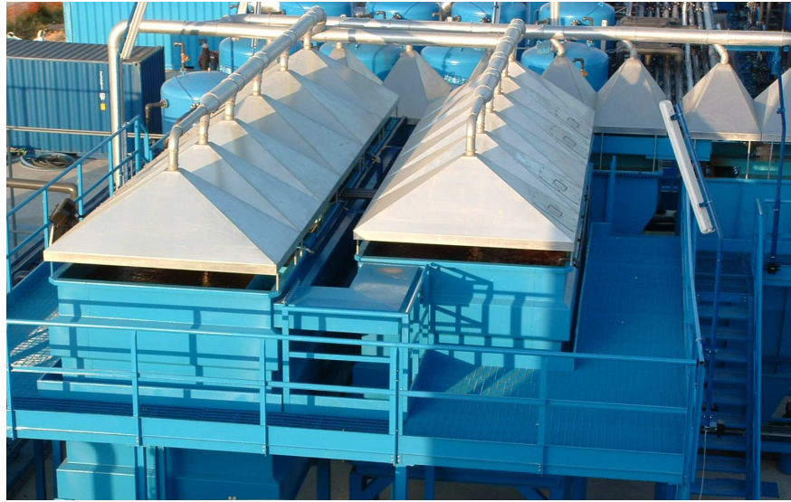
Figura 4 Tipica installazione del sistema di captazione dei vapori organici
