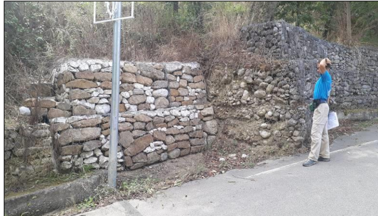
Figura 20 – Rottura dei gabbioni di contenimento ad opera di movimenti franosi attivi lungo strada a monte di Castel Fiego.
