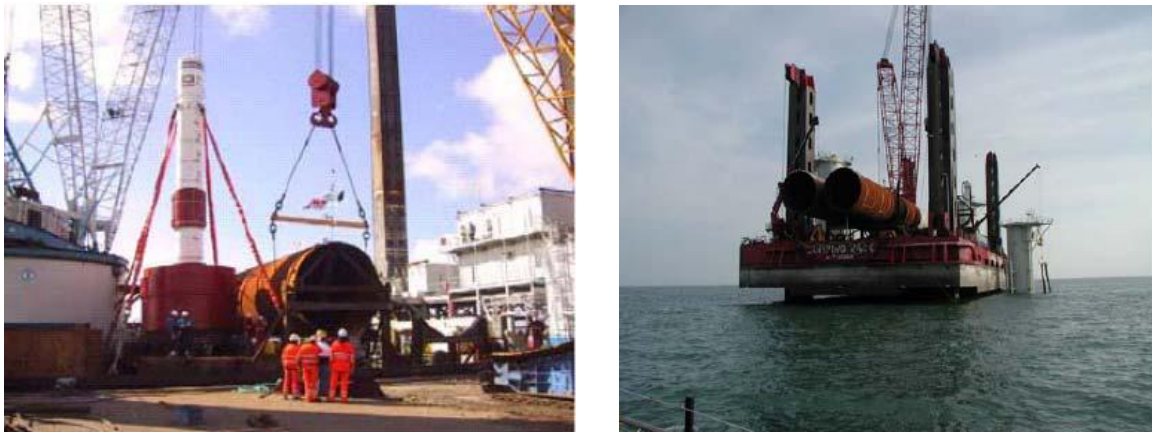
Figura 12: Caricamento dei pali di fondazione e fase di sollevamento del pontone nel punto di installazione dei pali di fondazione
