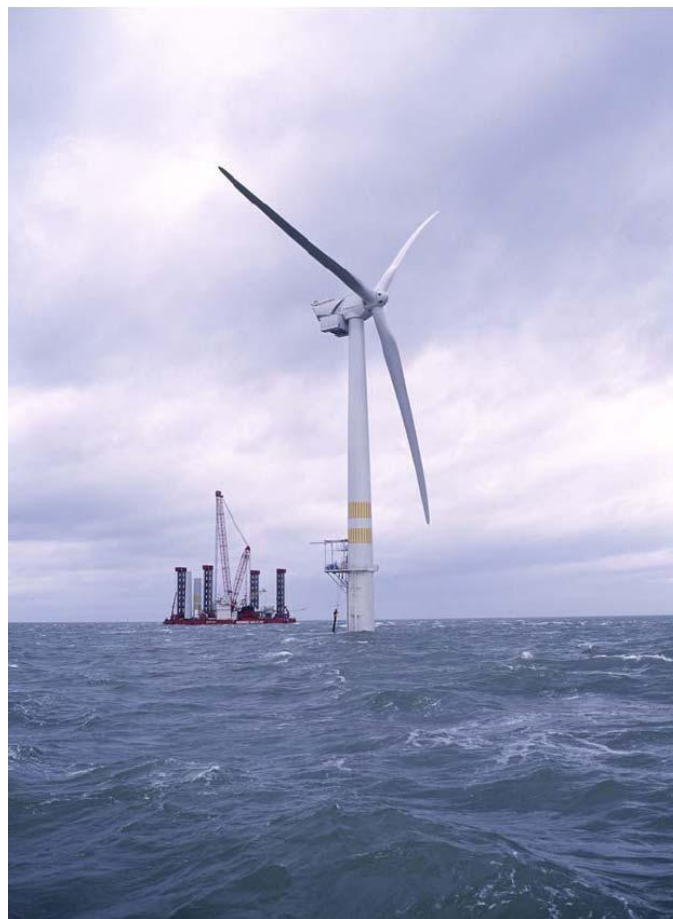
Figura 5: Turbina eolica da 3,0 MW installata in mare
