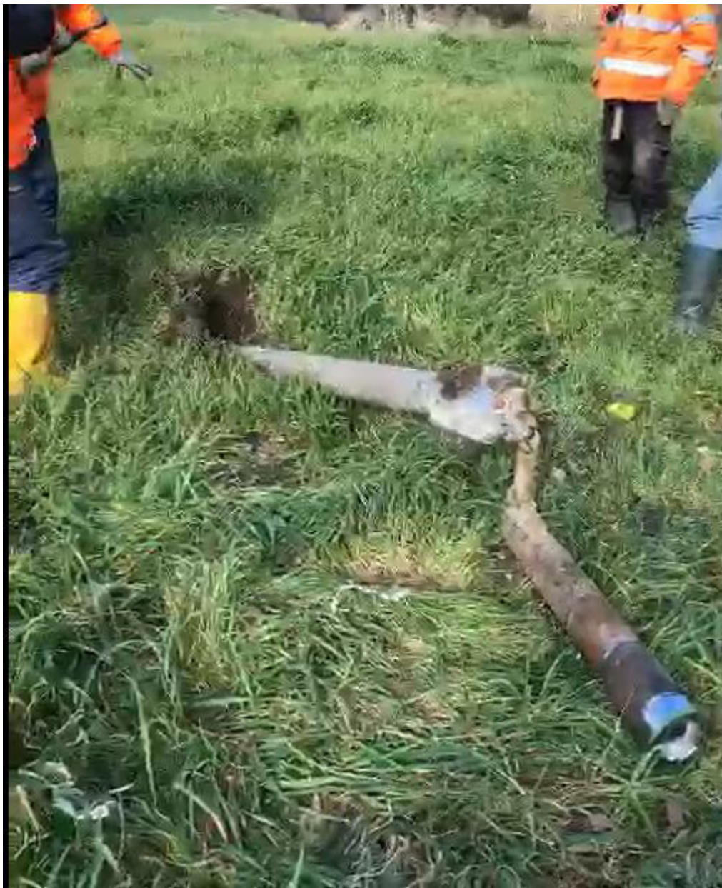
Figura3.b : Telecamera allacciata al dispositivo di ancoraggio
