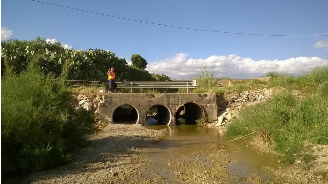
Figura 84 - Fosso Sparagogna_ Foto guado stradale
