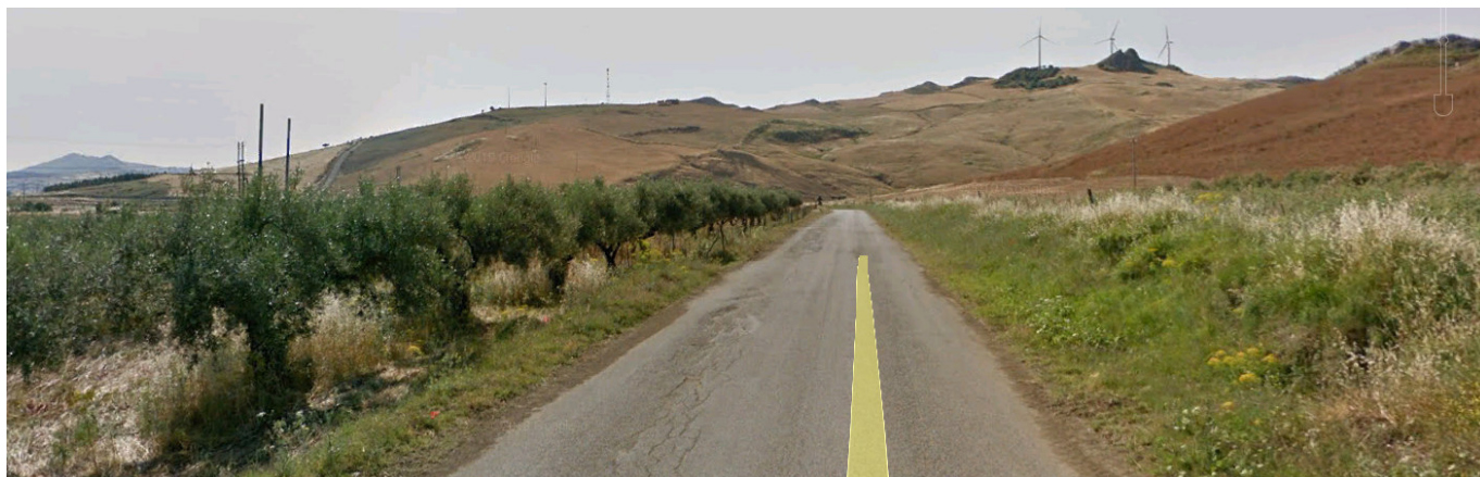
Stato di fatto: sezione trasversale S.S. 192- tratto tra progr. 25+780 e progr. 26+750 (progressive Anas)
