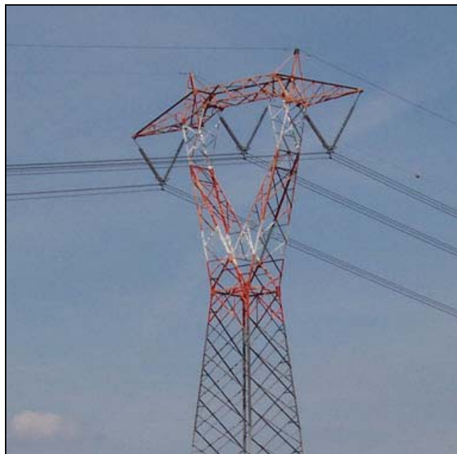
Figura III.24 - Sostegno 380 kV in singola terna
