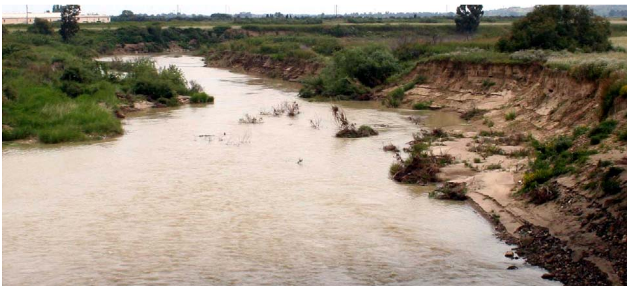
Figura 4.31 - Erosione al piede della scarpata fluviale del Simeto
