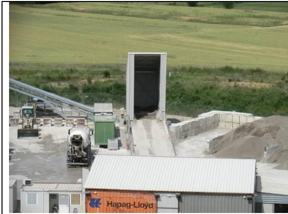
Tramoggia di alimentazione di un impianto di betonaggio: il punto di conferimento è completamente chiuso in una struttura e la connessione con il nastro estrattore-sollevatore dei materiali ai dosatori è in sotterraneo in struttura chiusa
