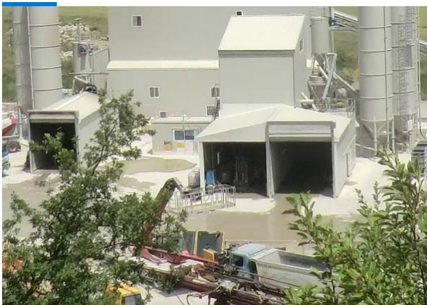
Punto di conferimento delle miscele alle betoniere ubicato in strutture chiuse, dotate di serrande e di sistemi di aspirazione.
