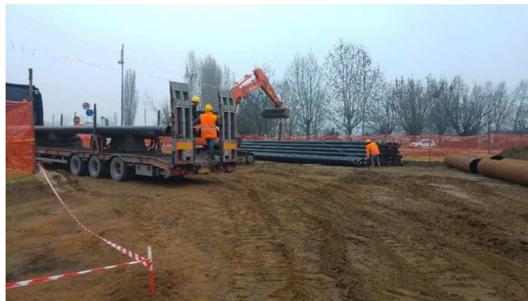
Figura 3.5.3: Esempio di area di lavoro/stoccaggio
