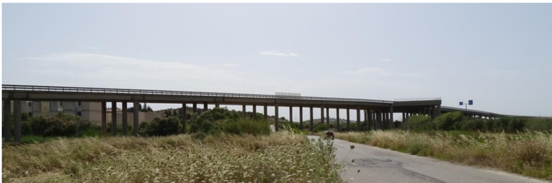
Figura 4.6.3: Vista panoramica sul raccordo stradale incompiuto
