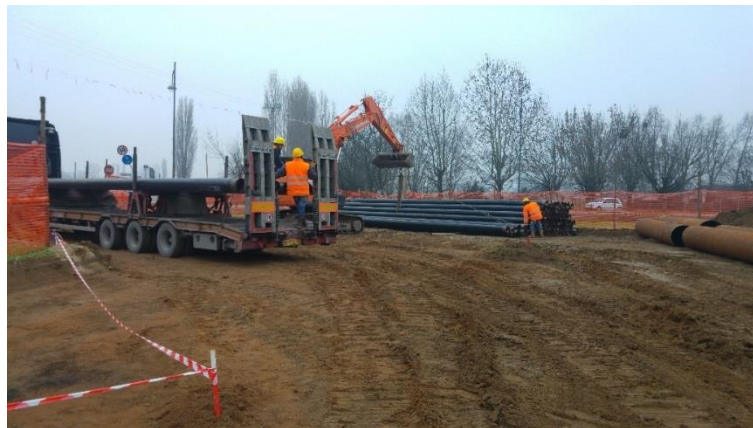
Figura 2.4.3: Esempio di area di lavoro/stoccaggio
