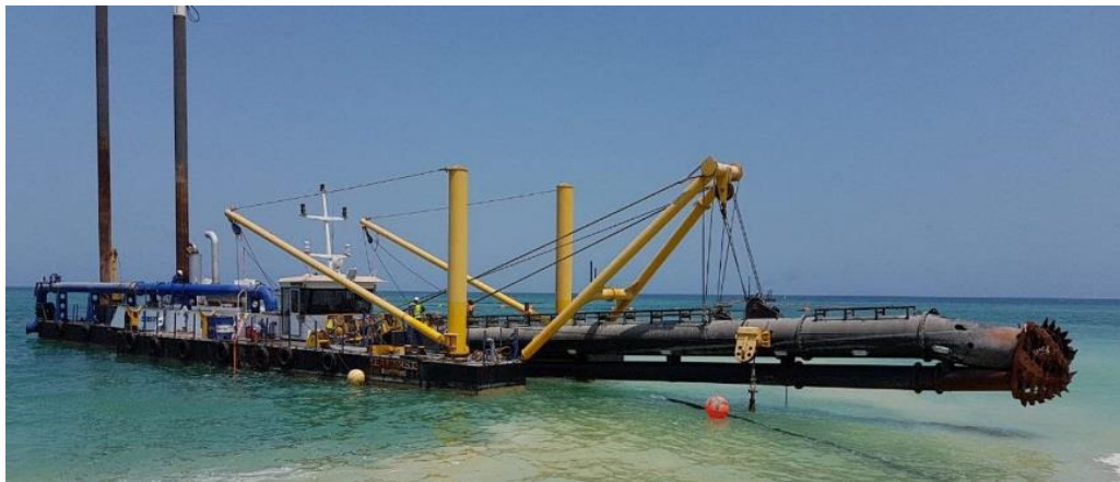
Figura 12: Xogħolijiet ta’ thejjija fil-ħruġ ta’ trinka tal- HDD ‘il barra mill-kosta – Eżempju ta’ Cutter Suction Dredger
