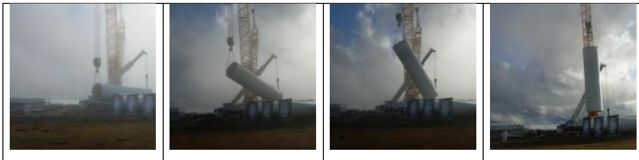
Figura 8.20 – Schema delle fasi di sollevamento dei componenti dell'aerogeneratore (Fonte sito web http://www.windfarmbop.com/ )
