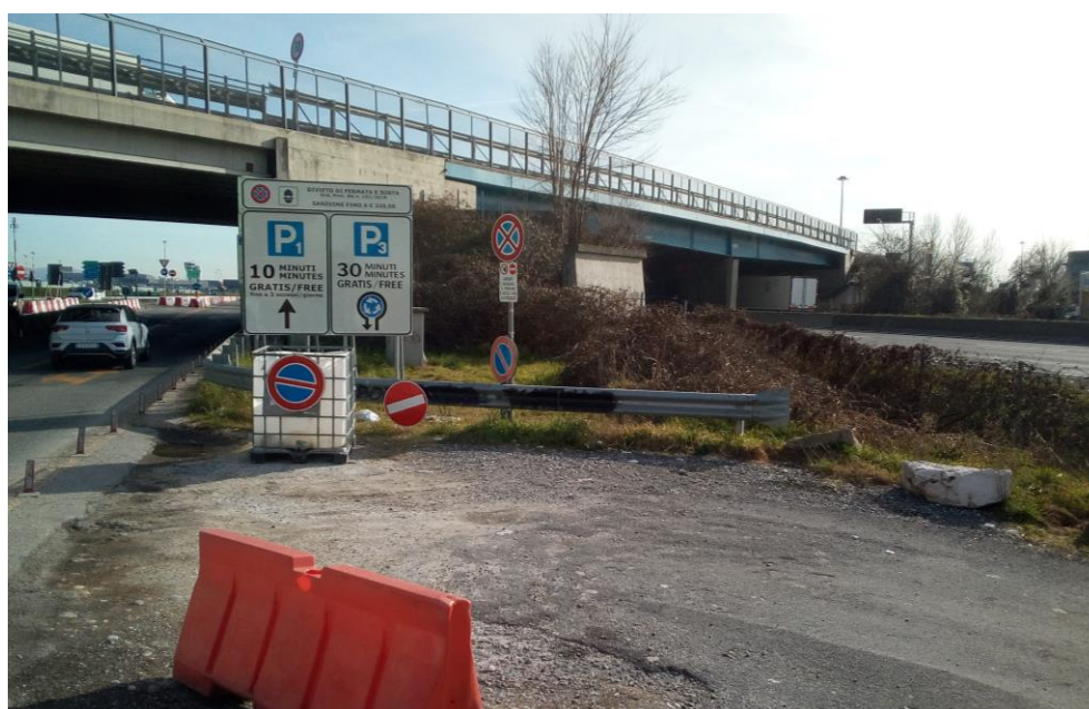
Vista della viabilità da utilizzarsi per l'uscita dal cantiere in direzione dell'aeroporto
