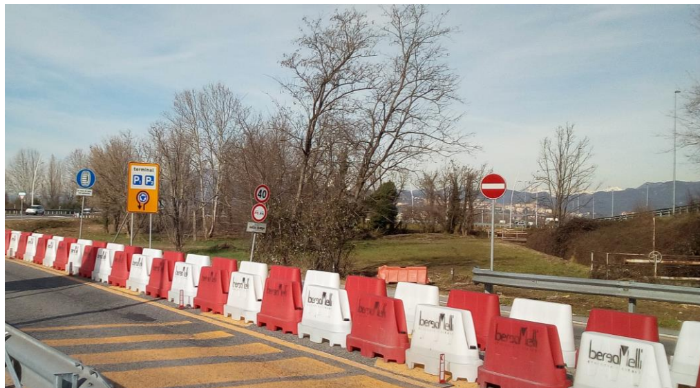
Foto1 - Vista del cantiere AT.05 dalla rampa del ramo di svincolo (fonte sopralluogo)
