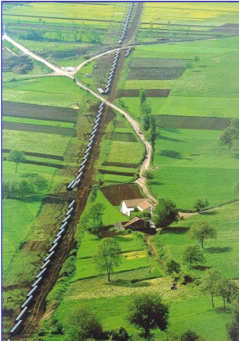
Foto II 5.1.3.A - Sfilamento tubazioni
