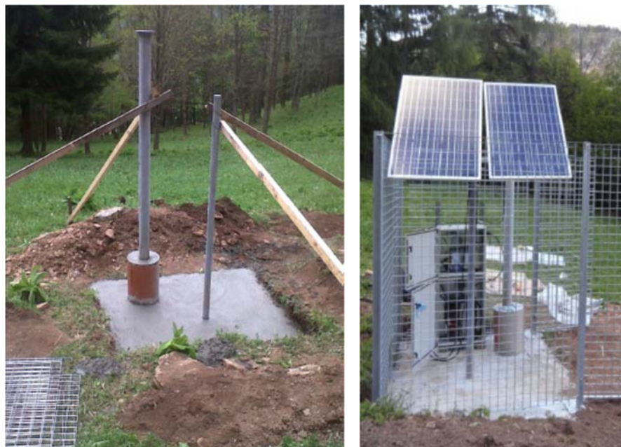
Figura 31 - Installazione tipo sensore con postazione alimentazione
