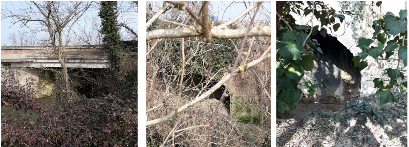
Figura 6 – Opera di attraversamento esistente sul Canale Dugale Tagliata: fornice centrale (foto a sinistra), fornici laterali (foto centrale e a destra).
