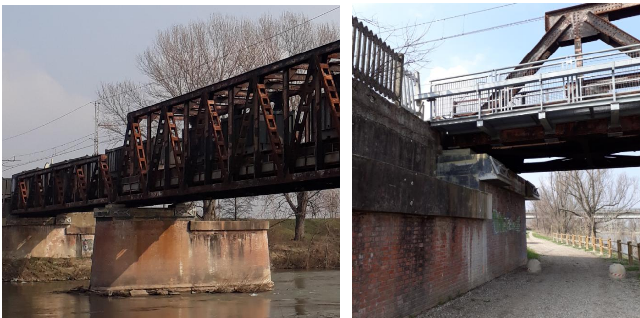
Figura 3 – Attraversamento ferroviario esistente sul Fiume Oglio: aumento dell'elevazione delle pile (a sinistra) e delle spalle (a destra) in corrispondenza degli appoggi.
