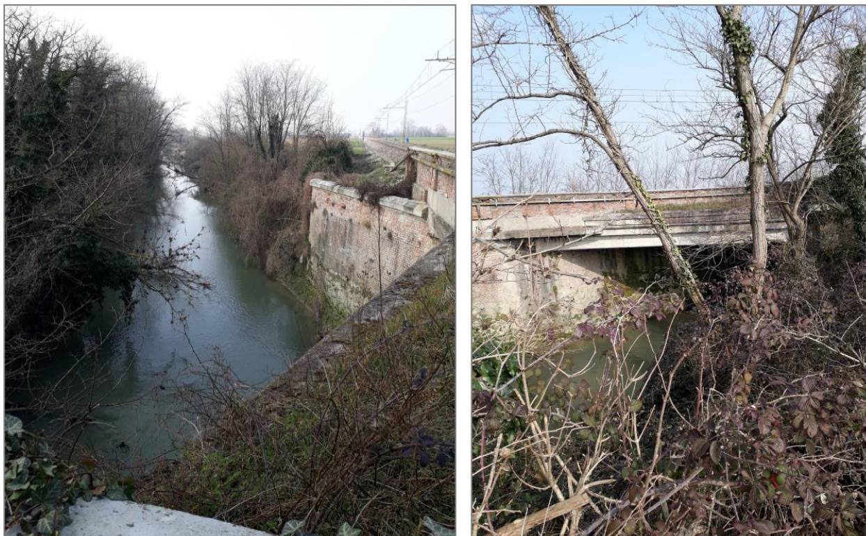
Figura 2: Ponte esistente sul Canale Dugale Tagliata (Cavo Delmona): foto configurazione attuale con vista dal Ponte esistente verso monte - zona interessata dalla realizzazione del nuovo attraversamento - (foto sx) e con vista da monte verso valle (foto dx). Fonte: sopralluogo ITALFERR del 19/02/ 2020
