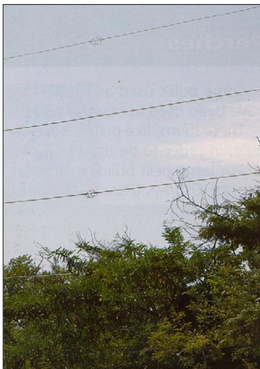
Spirali su cavi conduttori
